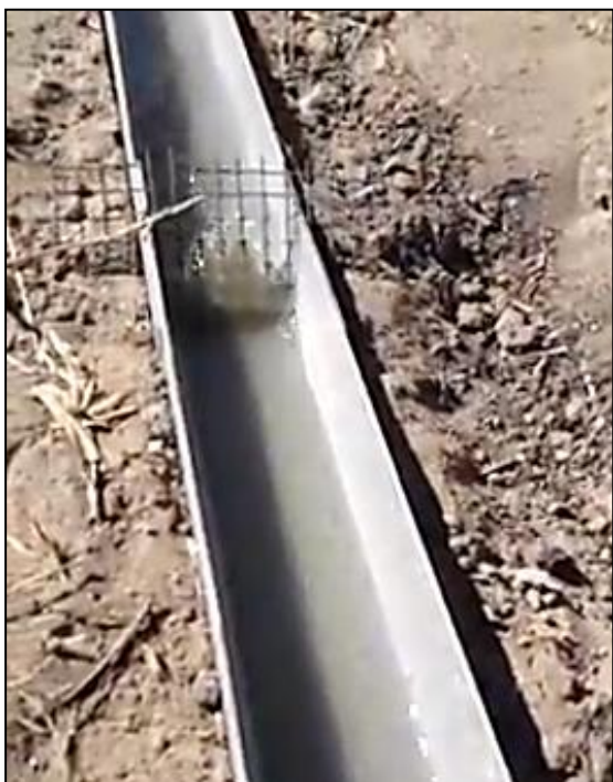
Figura 3.23. Retención de partículas, mediante rejillas
