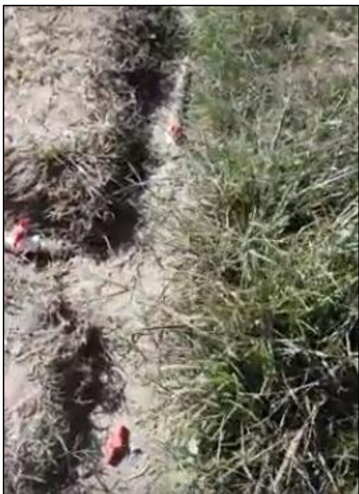
Figura 3.20. Tres válvulas, en el Sistema de tuberías
