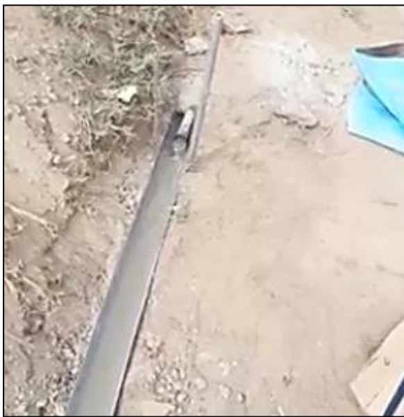
Figura 3.22. Agua residual desembocando, para atravesar la rejilla
