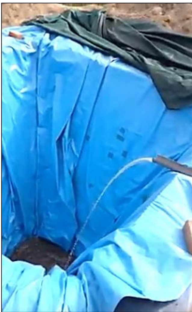
Figura 3.24. Agua residual, desembocando en la laguna anaerobia
