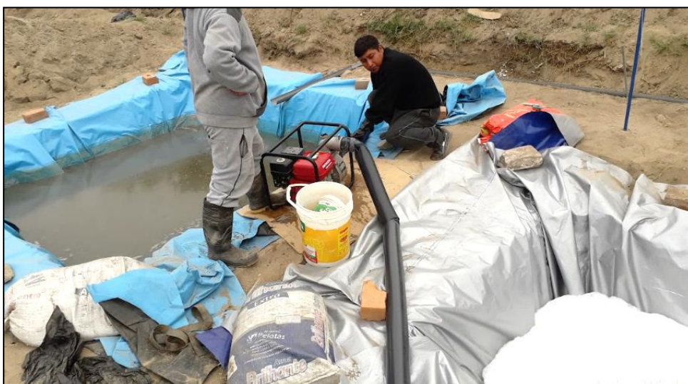
Figura 3.26. Trasvase de agua residual de la laguna primaria, hacia las lagunas secundarias
