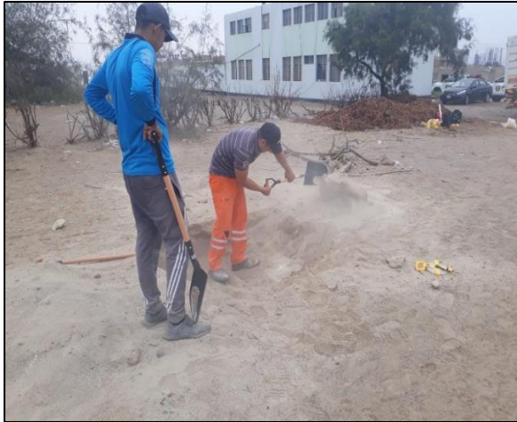
Fotografía: Cerrado de la excavación y culminación de la exploración del terreno.
