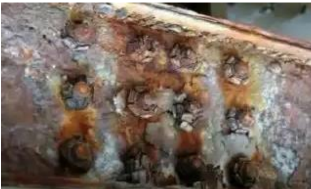
Fig. 19. Corrosión por hendidura. (Fuente: Brasunas, A)
