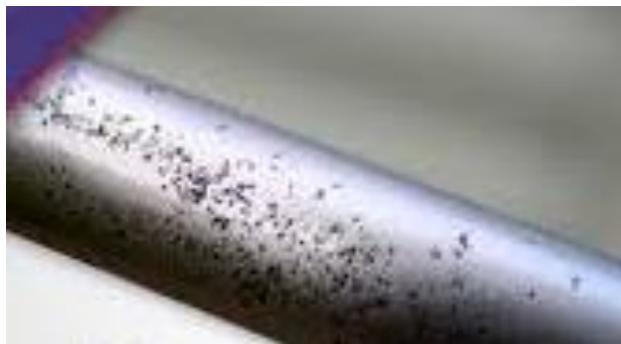
Fig. 12. Corrosión por picadura de un tubo de acero (fuente: Brasunas, A.)
