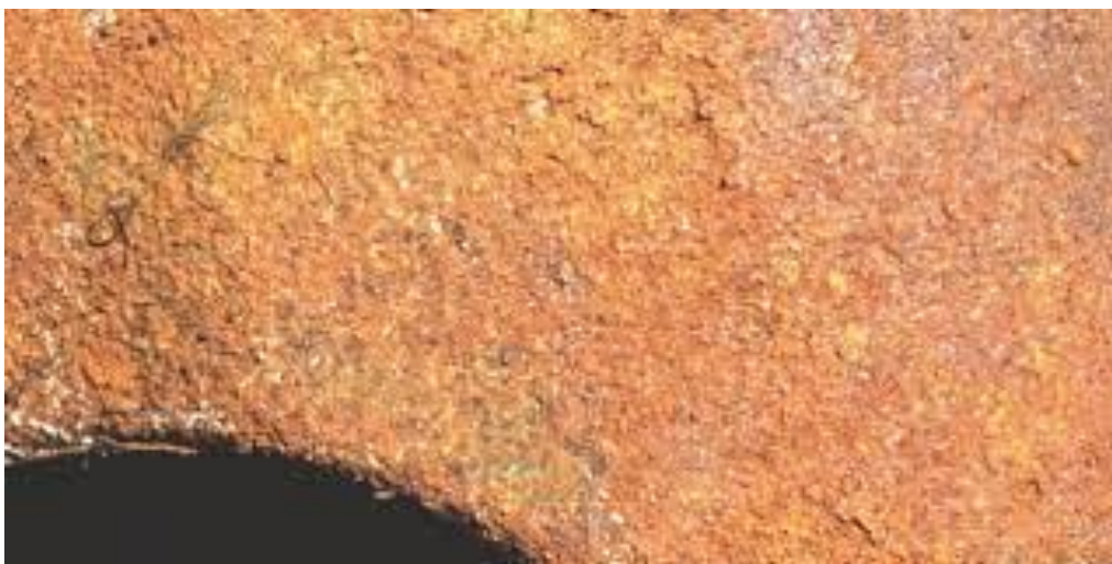
Fig. 10. Corrosión uniforme. (Fuente Brasunas, A.)
