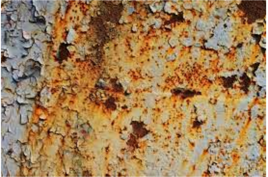
Fig. 11. Corrosión por picadura. (Fuente: Brasunas, A.)
