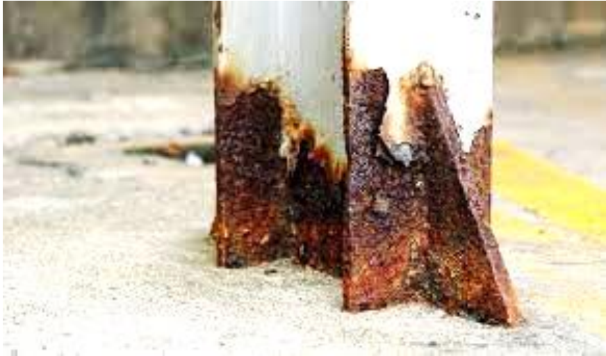
Fig. 9. Corrosión de metal (Fuente: Brasunas, A)
