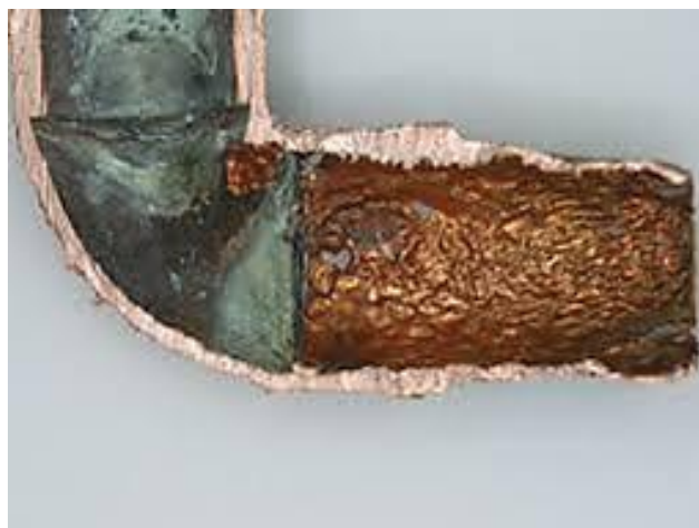
Fig.13. Corrosión total de una tubería. (Fuente: Brasunas, A.)
