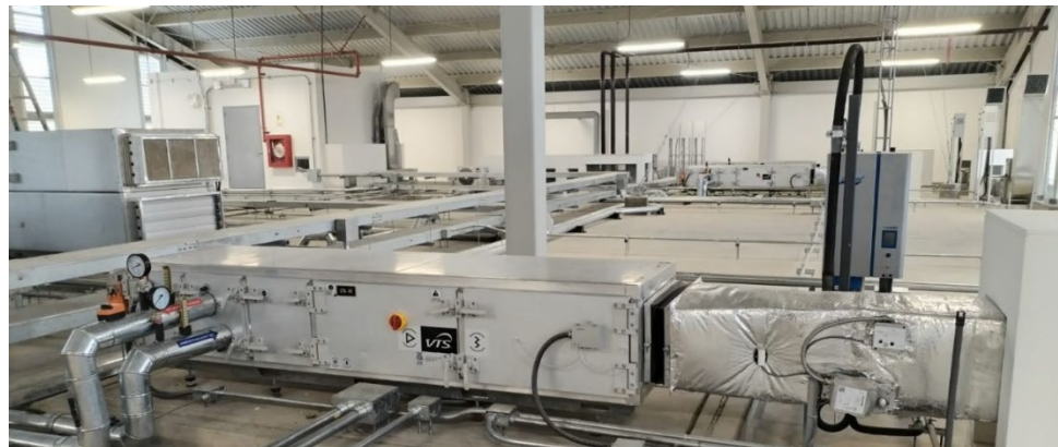
Figura N°11: Unidad de Tratamiento de aire (UTA)
