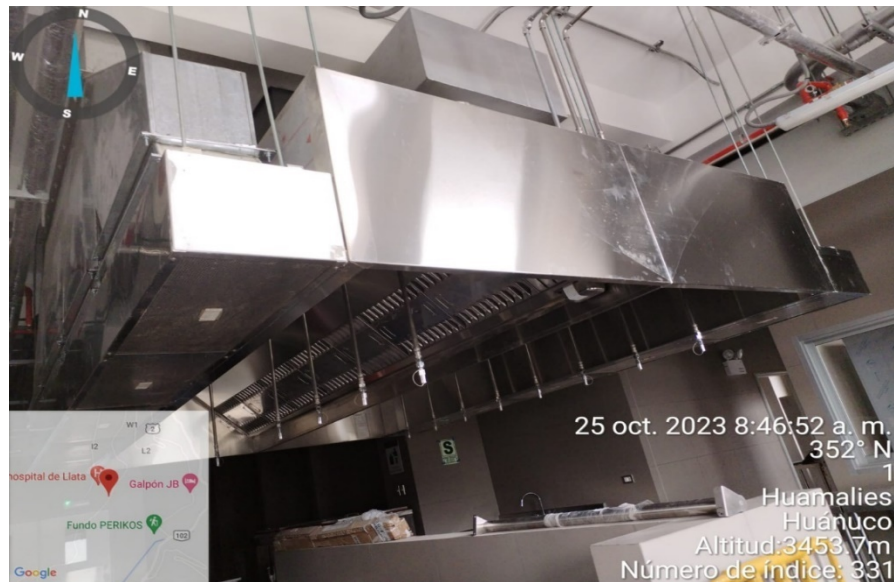
Figura N°31: Campana de extracción de cocina de 7m x 3m.
