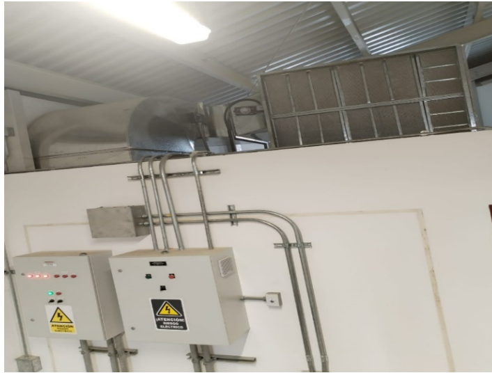
Figura N°27: Tablero de conexión con el equipo de presurizacion de escalera.
