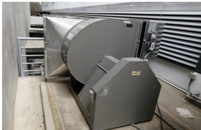
Figura N°26: Equipo de presurización de escalera.
