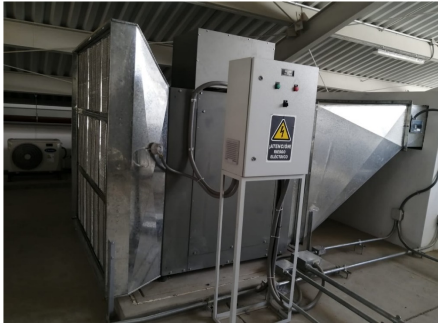
Figura N°29: Equipo y tablero de inyector de cocina.
