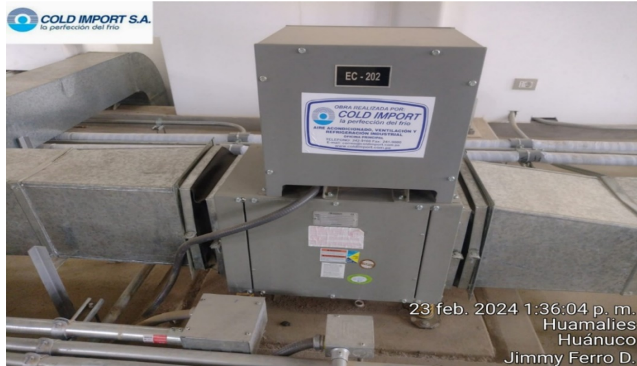
Figura N°19: Equipo de ventilación mecánica tipo gabinete.
