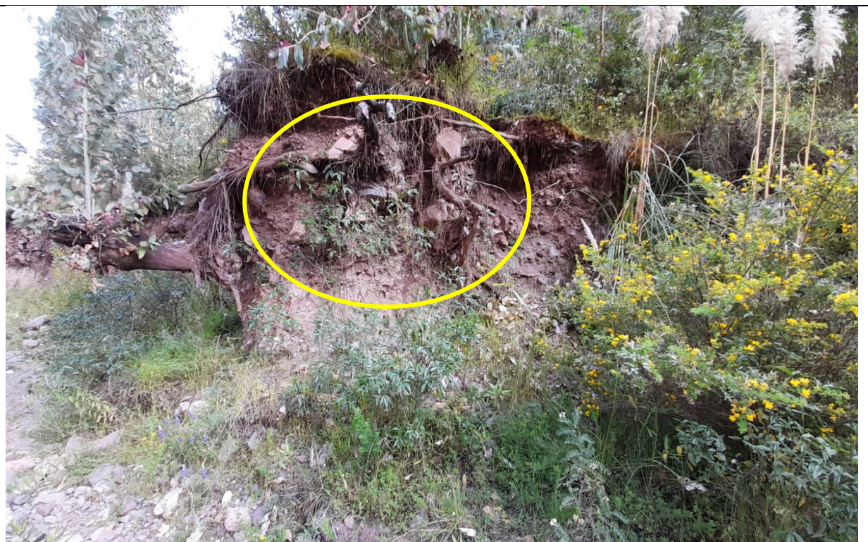
Foto 08: Sección colapsada del paramento del encauce arqueológico del río Chacan. Gessica Cedano; 2022
