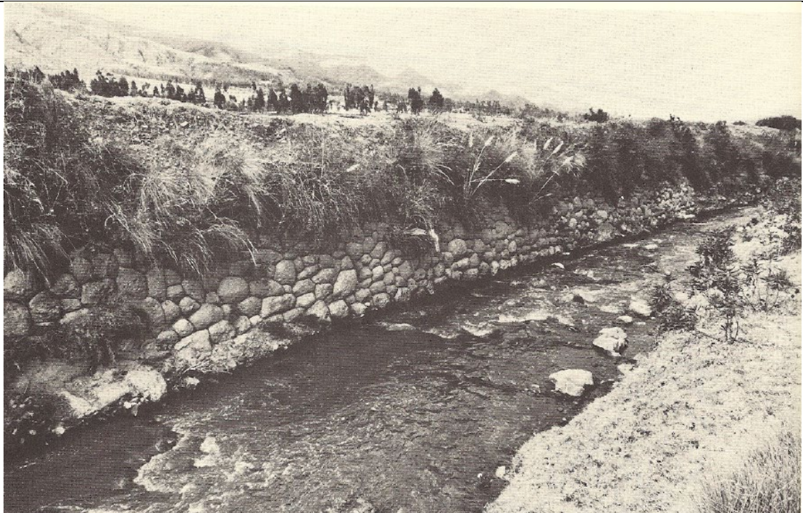
Foto 02: Restos de las obras de canalización del río Huatanay a unos diez kilómetros del centro de la ciudad. Fuente: Gasparini y Margolies; 1977: 60
