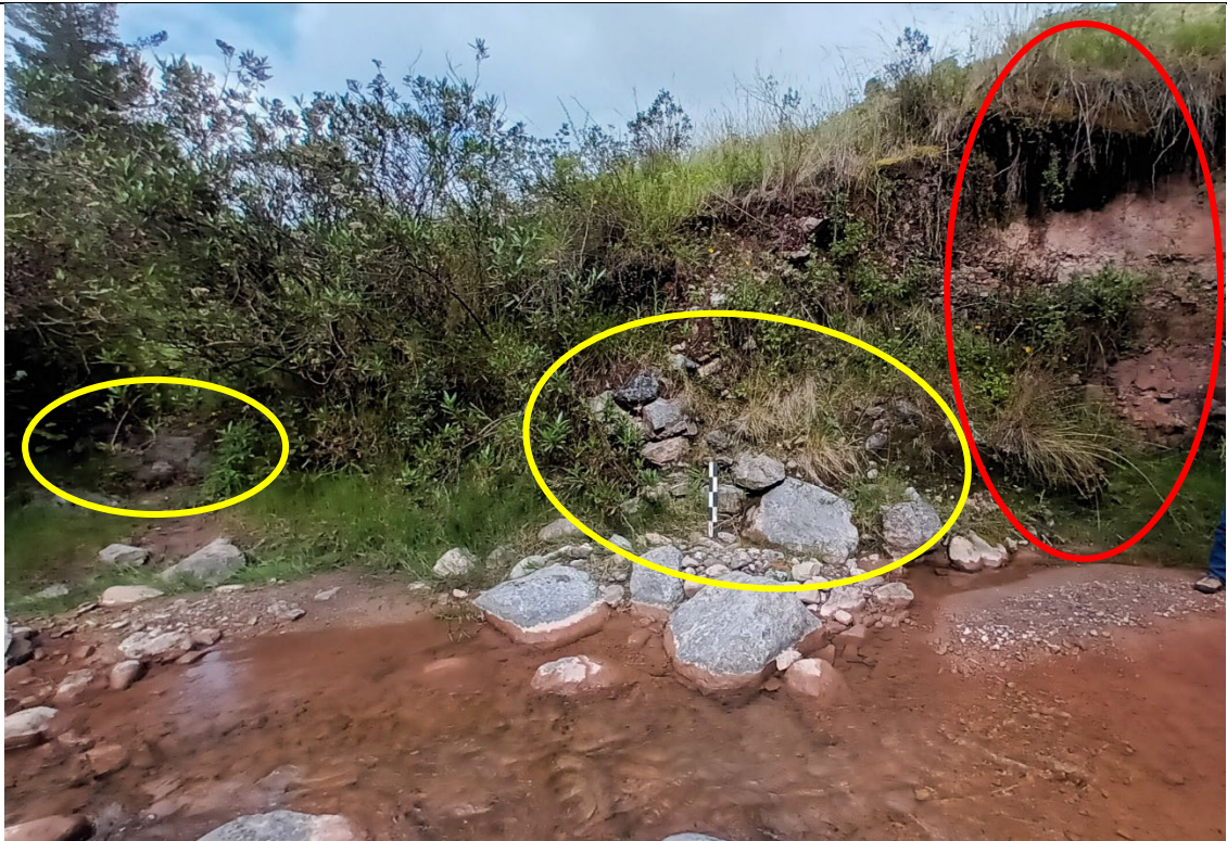
Foto 12: Vista de las bases del paramento del encauce arqueológico del río Chacan (círculo amarillo). Nótese que en la sección donde el encauce ha colapsado el perfil se encuentra inestable (círculo rojo). Gessica Cedano; 2022
