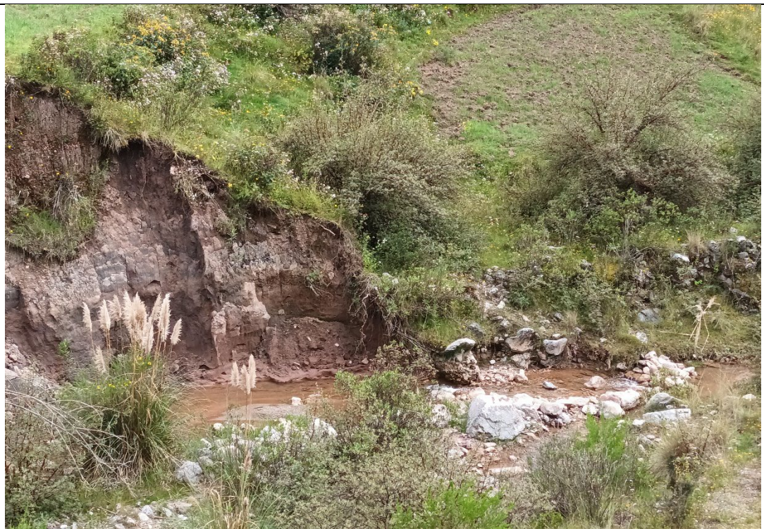
Foto 04: Margen del río Chacan con menor presencia de vegetación, mostrando un perfil inestable. Gessica Cedano; 2022
