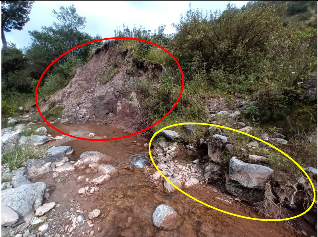
Foto 11: Vista de las bases del paramento del encauce arqueológico del río Chacan (círculo amarillo). Nótese que en la sección donde el encauce ha colapsado el perfil se encuentra inestable (círculo rojo). Gessica Cedano; 2022
