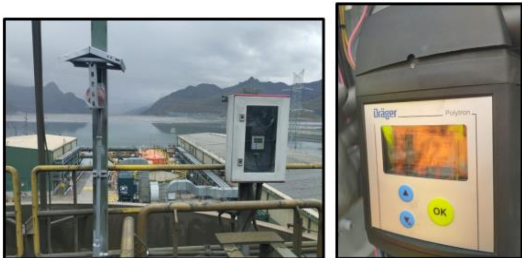
Fig. 23 Sistema de sensado de gas H 2 S (izq.), Calibración del sensor H 2 S (der.).
