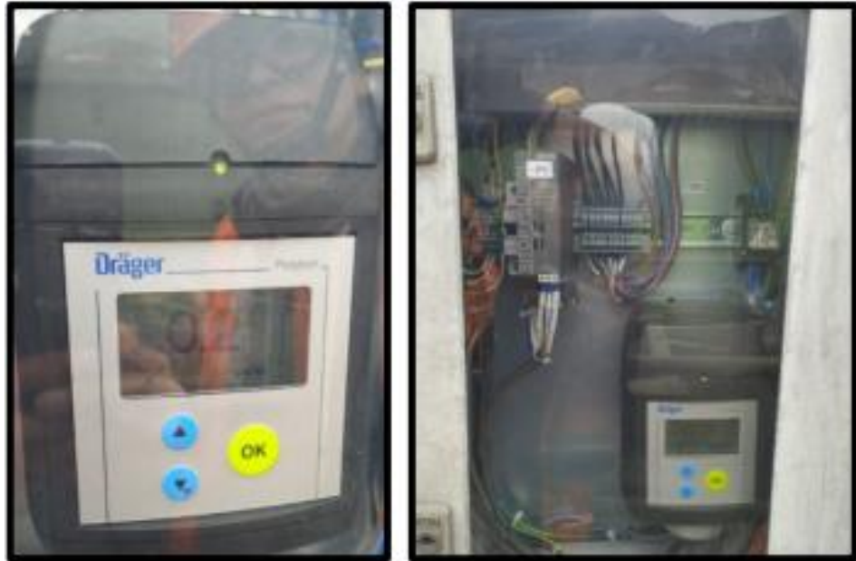
Fig. 22 Lectura de sensor (izq.), Tablero de funcionamiento (der.).
