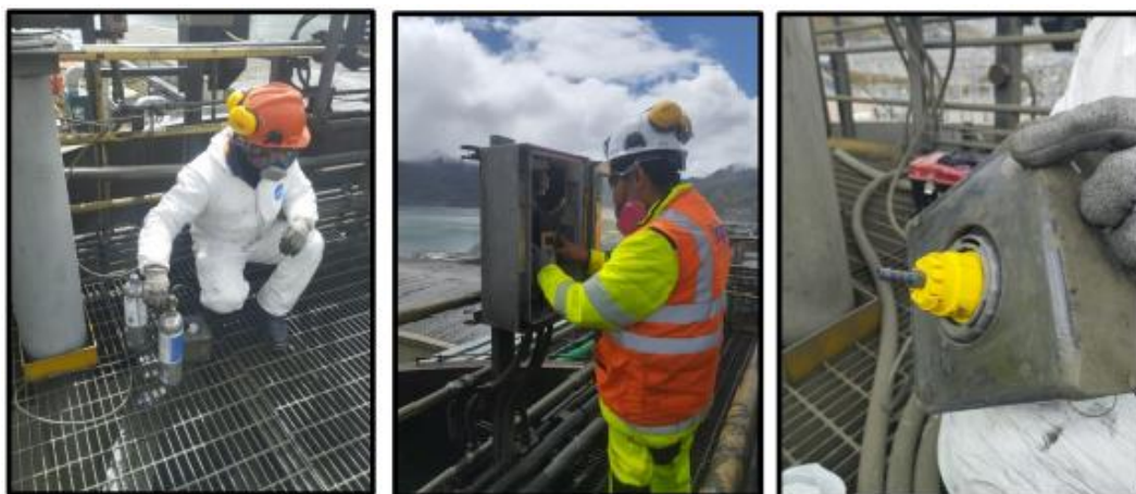
Fig. 24 Apoyo en calibración con Dragger (izq.), Calibración por parte de Dragger (centro) e Instalación de protector (der.).
