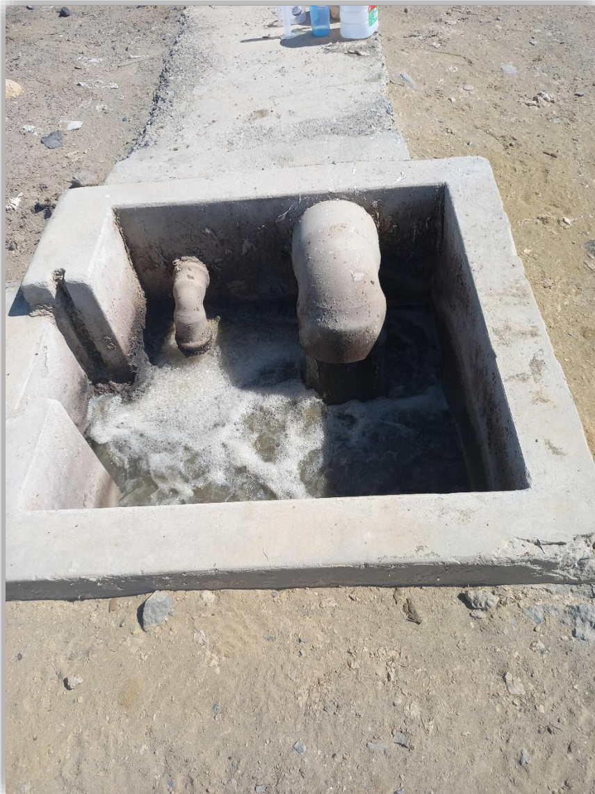
Foto 02: Ingreso del agua residual
