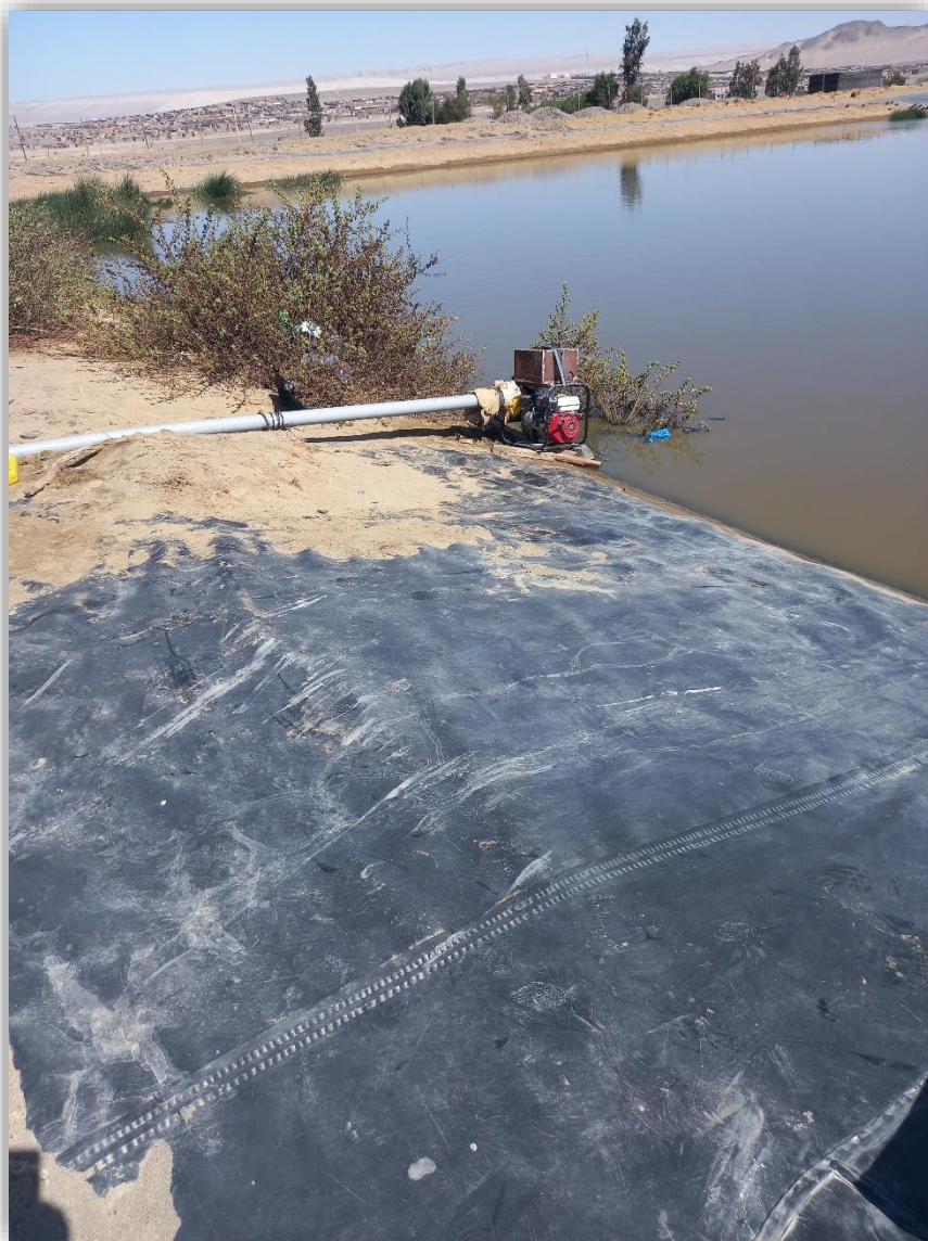
Foto 10: Motor de bombeo de los efluentes
