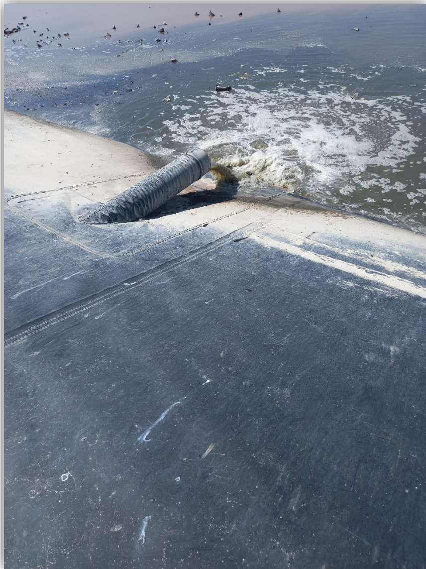
Foto 05: Tubo de alimentación a la laguna de estabilización
