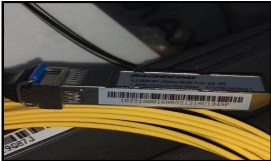
Fig. 70. Imagen de los módulos de fibra óptica en nodo
