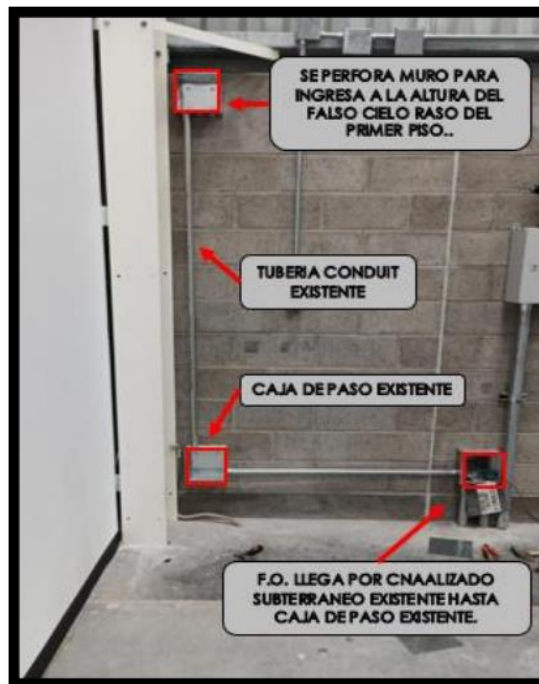
Fig. 15. Recorrido de fibra óptica por caja de paso
