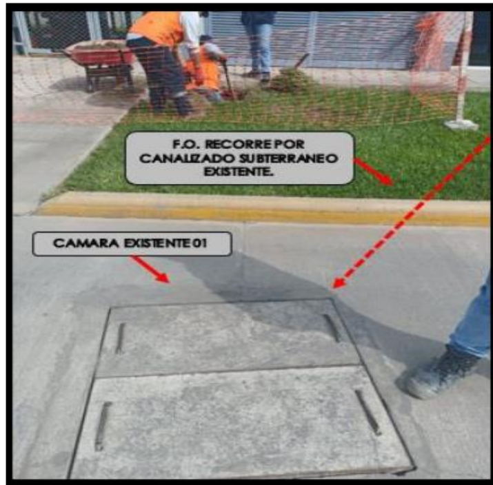
Fig. 14. Recorrido de fibra óptica por ductos subterráneos
