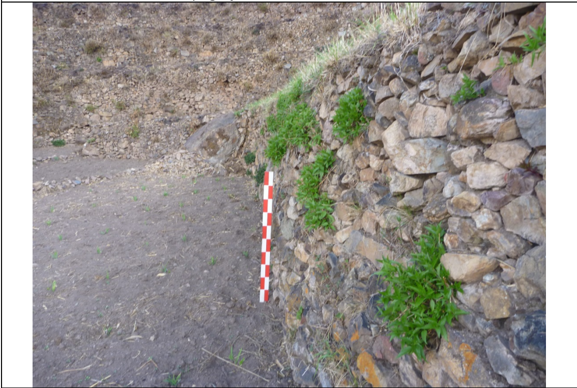
Foto 18: Crecimiento de pastos rastreros en el paramento de los andenes.
