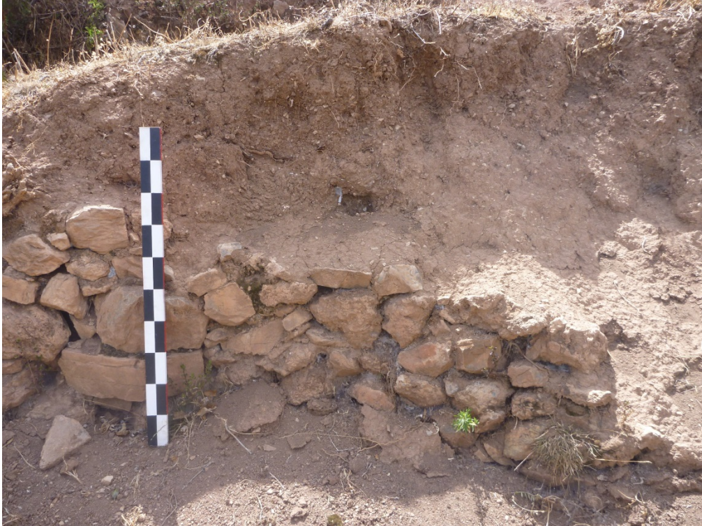
Foto 15: Colapso del muro de contención y vista del interior de la plataforma agrícola.
