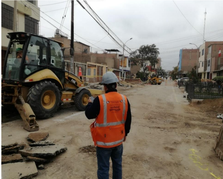
Figura. 23: Corte y rotura de pavimento flexible
