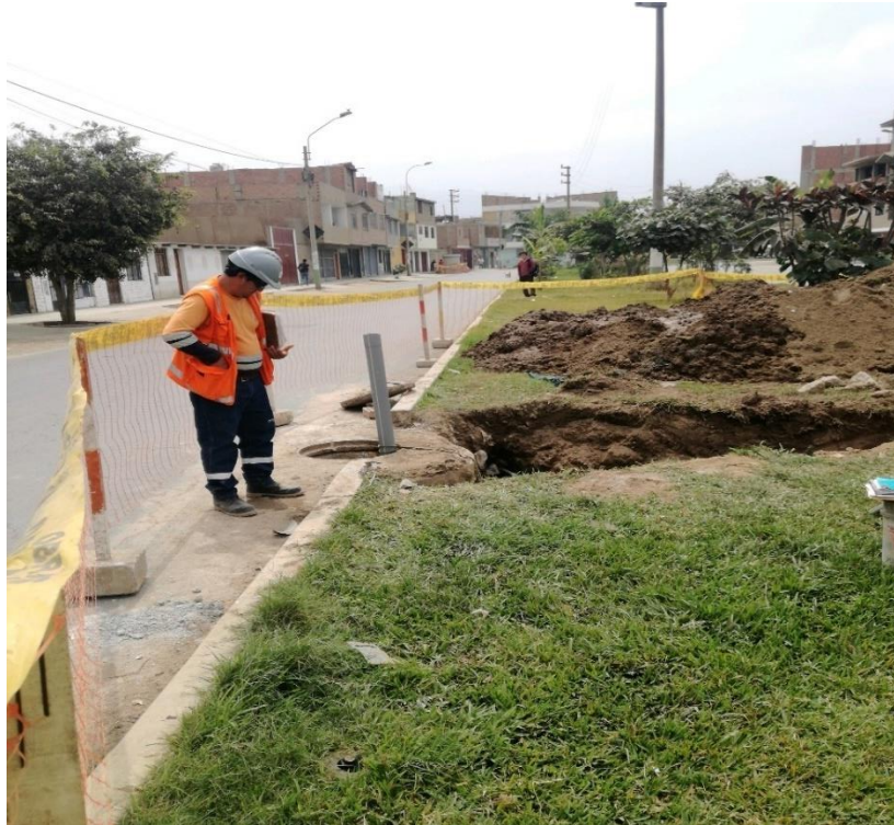
Figura. 50: Malla y cinta de seguridad
