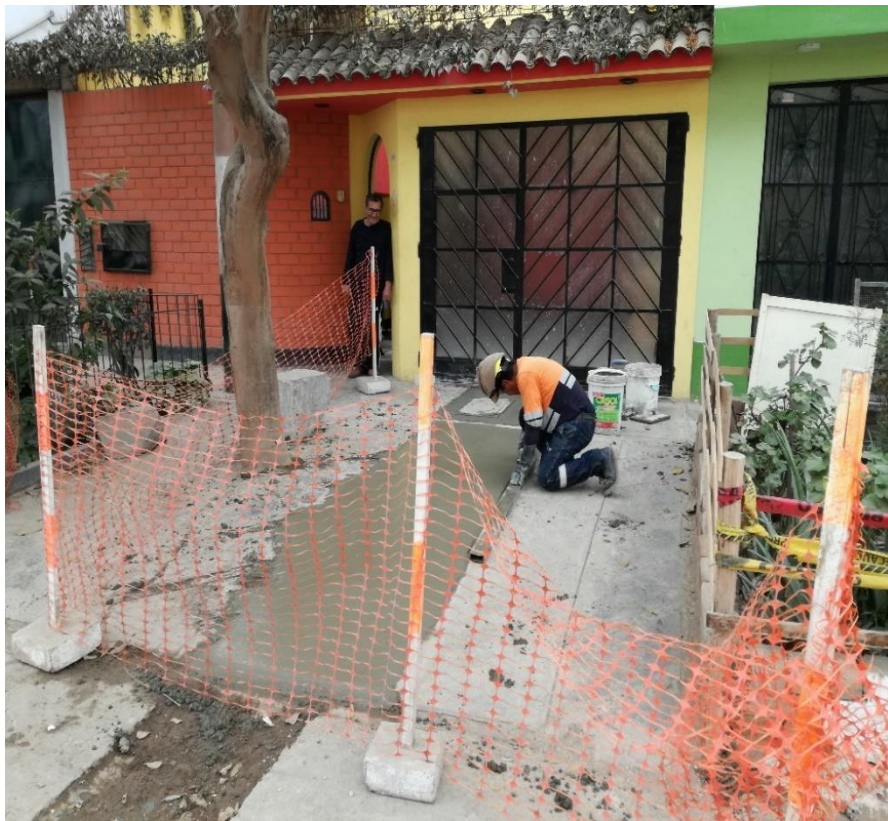
Figura. 49: Malla de seguridad
