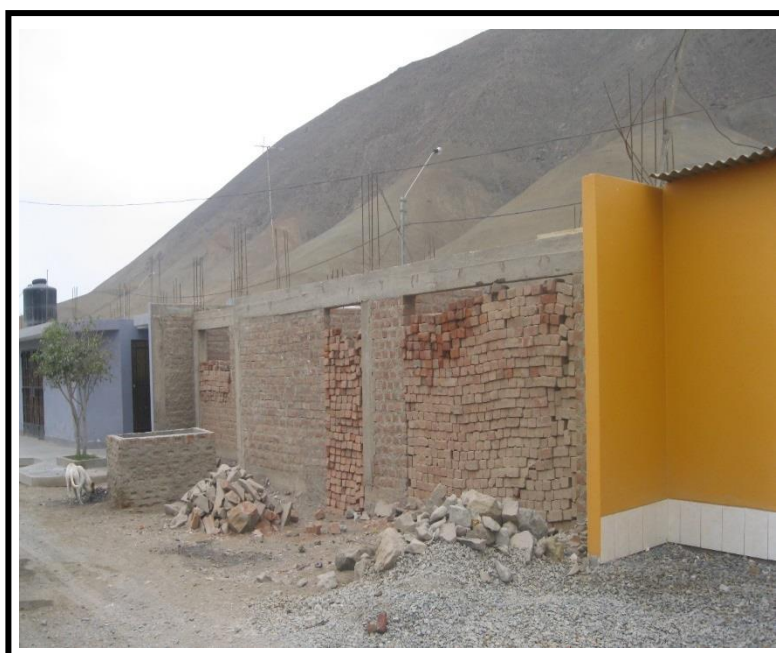
FOTO N° 04: Se observa uno de las construcciones abandonadas, sin habitantes.
