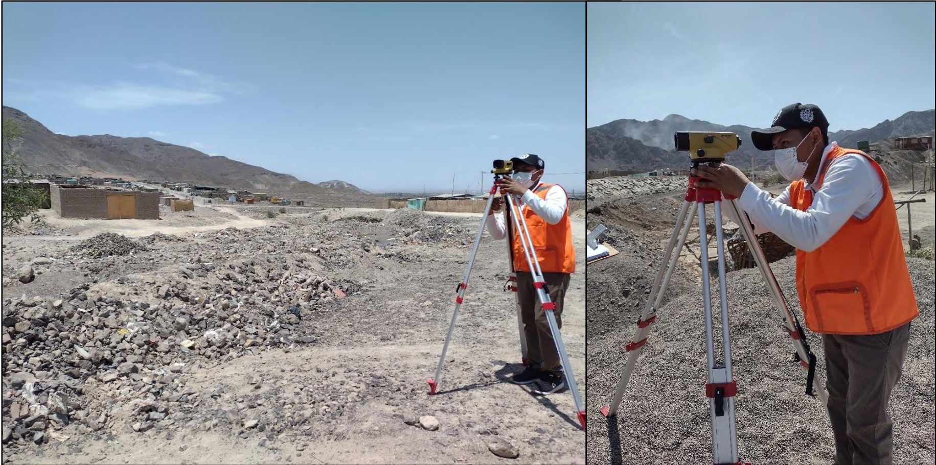
Fig. 32: Fotos del Trabajos de campo – Levantamiento Topográfico de las secciones transversales identificadas en el cauce de la torrentera del distrito de Vista Alegre, provincia de Nasca, región Ica. (Imagen derecha parte alta del cauce, e imagen izquierda parte baja del cauce respectivamente)
