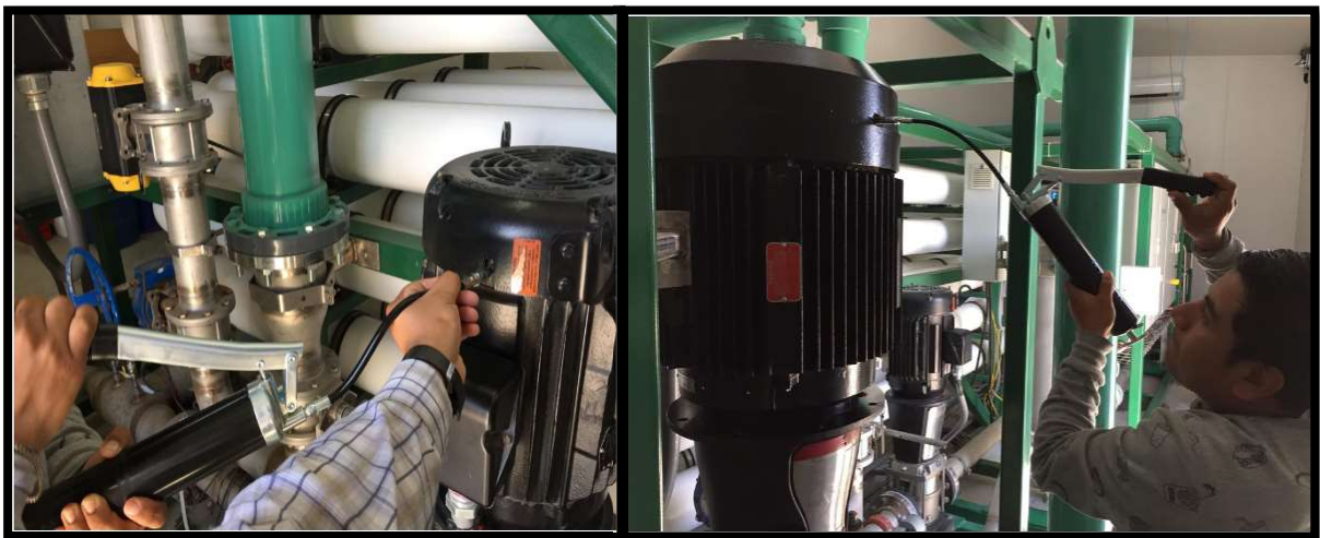
Figura No 21: Se realizo el engrase o lubricación a los rodamientos superior e inferior de los motores de las 03 bombas del sistema por Osmosis Inversa.
