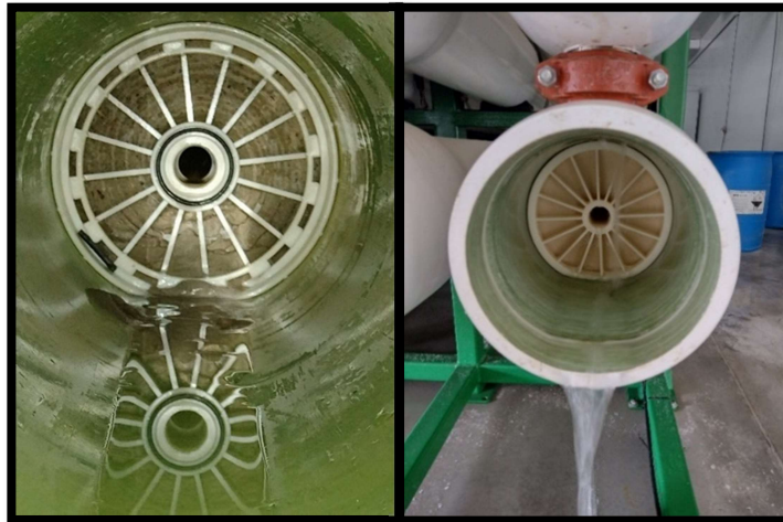
Figura No 9: Costras de Caliche alojados en los tubos de presión
