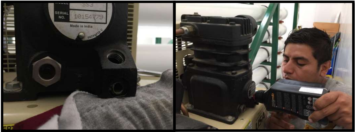
Figura No 22: Se realizo el cambio de aceite y filtros al compresor de aire.
