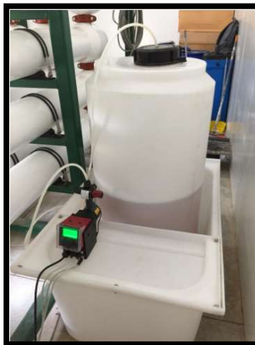
Figura No 16: Se lleno el tanque de químicos con el antiescalante, siempre verificando que el nivel no llegue al mínimo, además se verifico el cebado de la bomba dosificadora.
