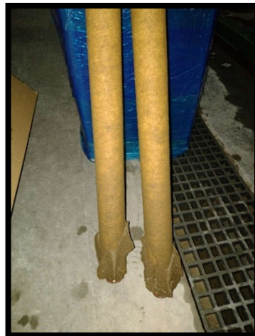
Figura No 10: Filtros de Cartucho saturados con arena
