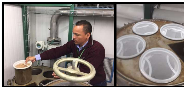
Figura No 16: Se realizo el cambio de los filtros de Bolsa
