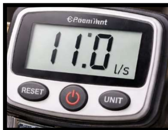
Figura No 14: medición del caudal del agua permeada, el cual ha disminuido debido a la saturación de las membranas del sistema.
