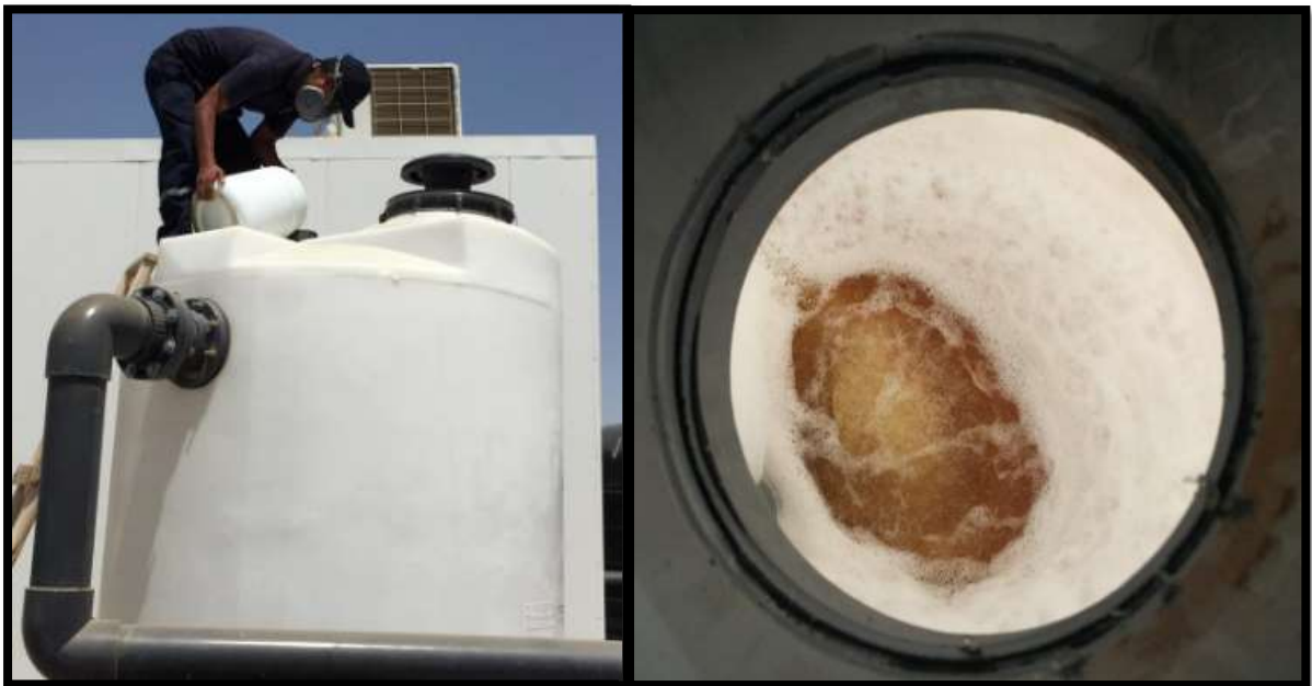
Figura No 23: Se realizo la limpieza química a las membranas de los equipos.
