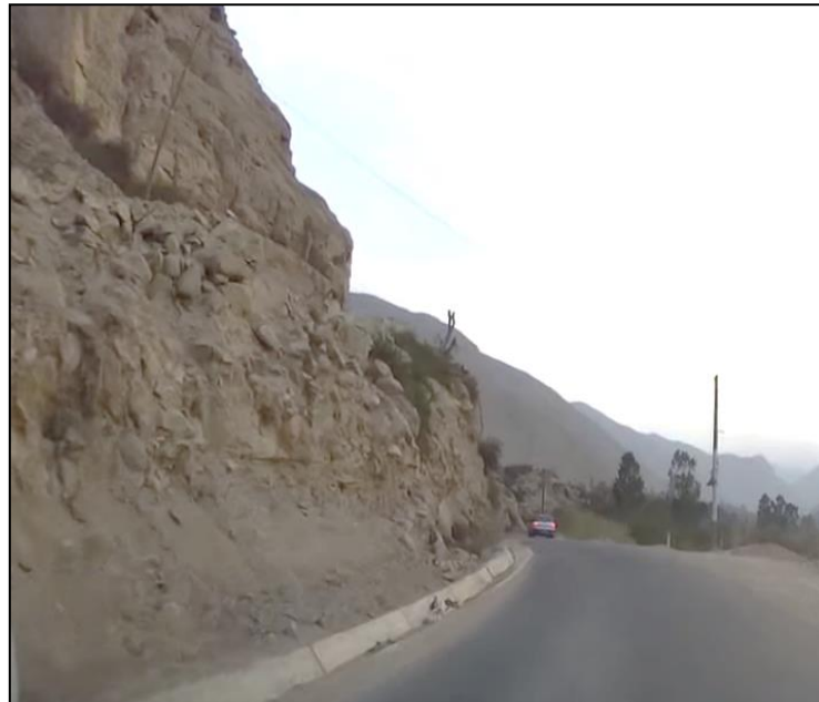
FOTO N° 03: Tramo de la carreta en el kilómetro 7.00 del inicio, zona característica de deslizamientos y derrumbes.
