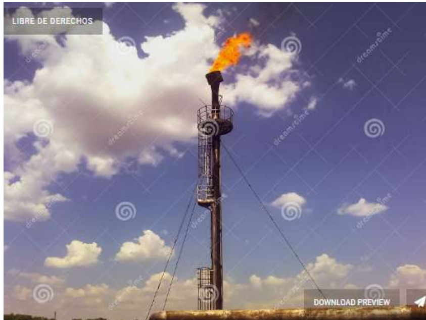
Fig. 14: Flare en funcionamiento como respaldo
