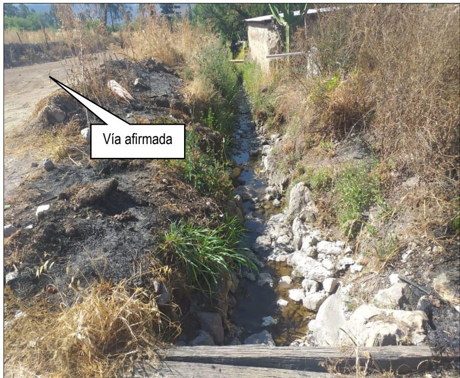
Fig. 15: Vista interna del canal natural con escombros.
