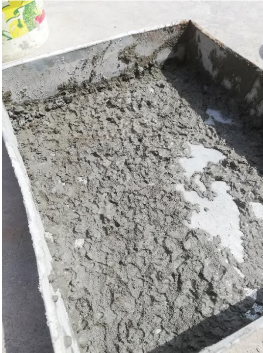
Muestra de la segregación de la mezcla
