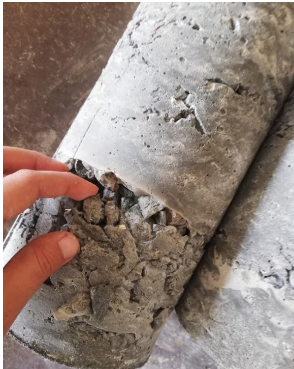
Segregación del concreto con una dosificación no apropiada
