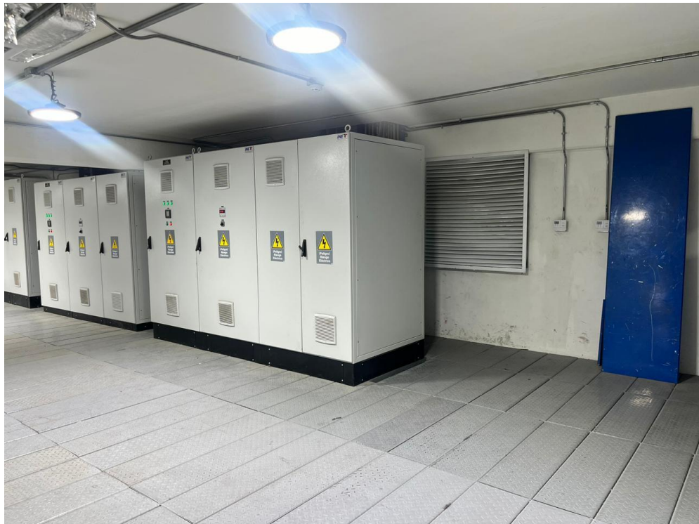
Fig. 22 Tableros baja tensión Subestación eléctrica 1F
