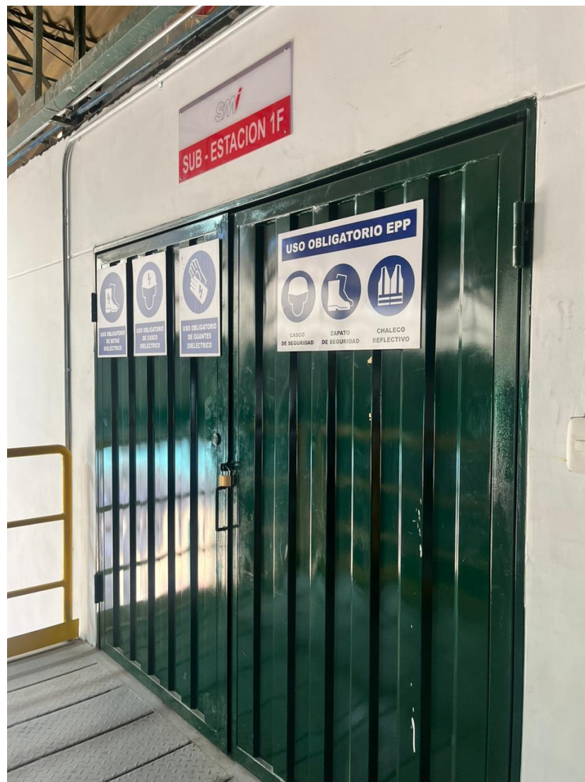
Fig. 21 Ingreso Subestación eléctrica 1F
