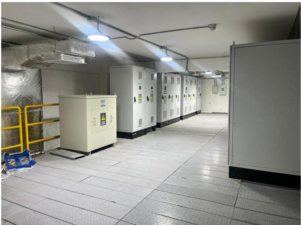
Fig. 23 Tableros baja tensión Subestación eléctrica 1F continuación
