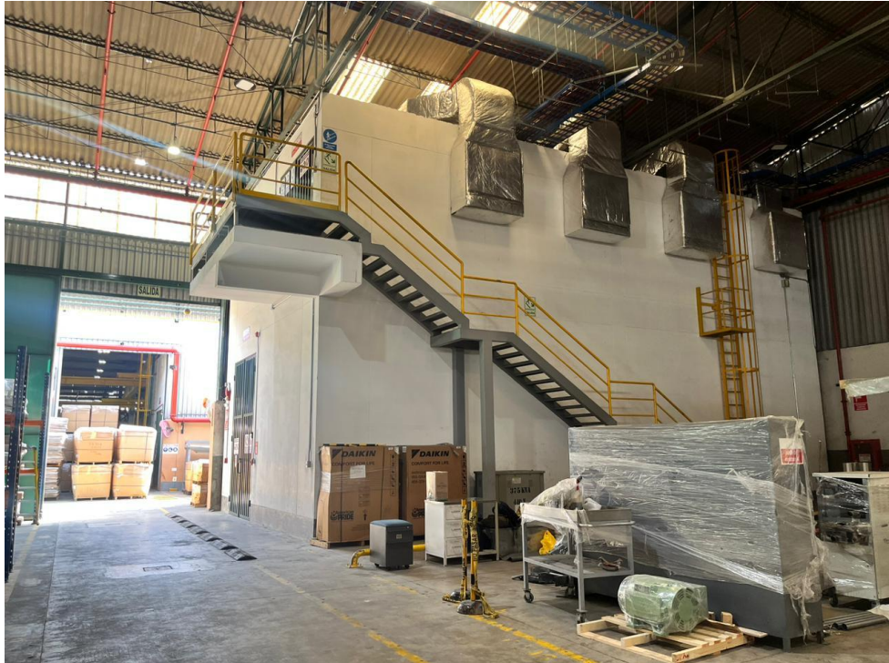
Fig. 24 Subestación eléctrica 1F
