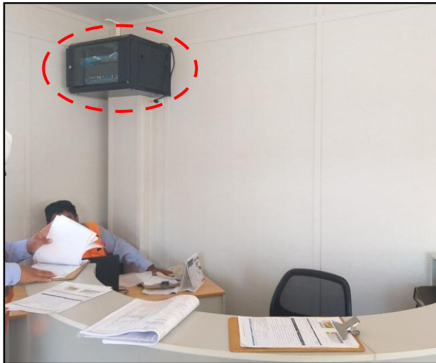
Figura 7: Garita – Gabinete de Comunicaciones del Cliente.
