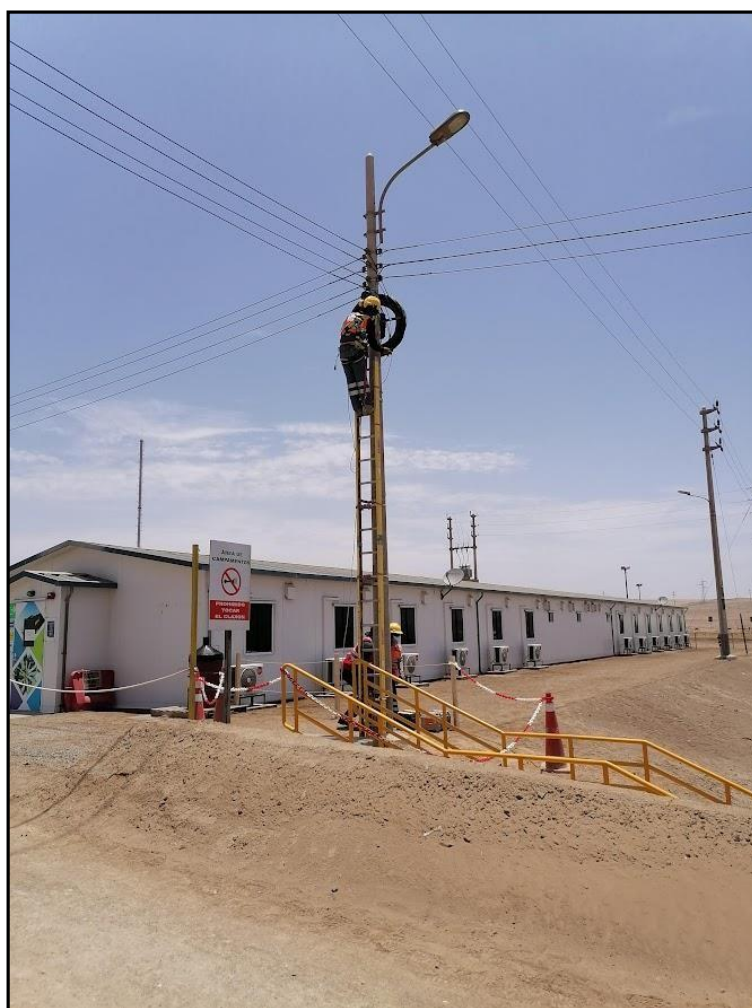
Figura 70: 4521 – PERMANENT CAMP / Reutilización de poste para tendido aéreo.
