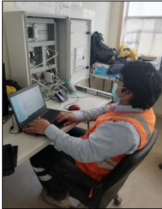
Figura 49: Pruebas a dispositivos del sistema de Control de Acceso.
