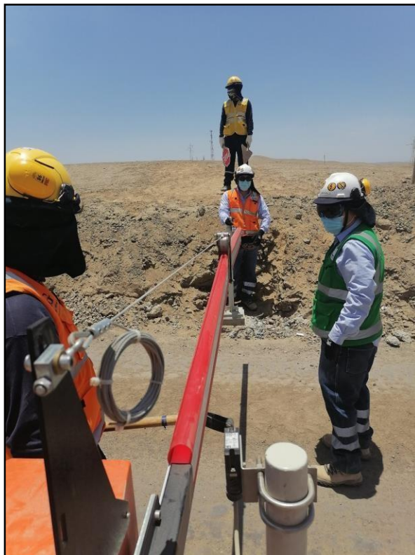
Figura 46: Instalación dispositivos de control de acceso.
