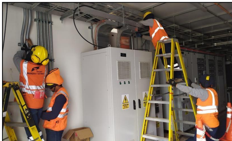
Figura 42: Canalización Conduit RGS en salas eléctricas.
