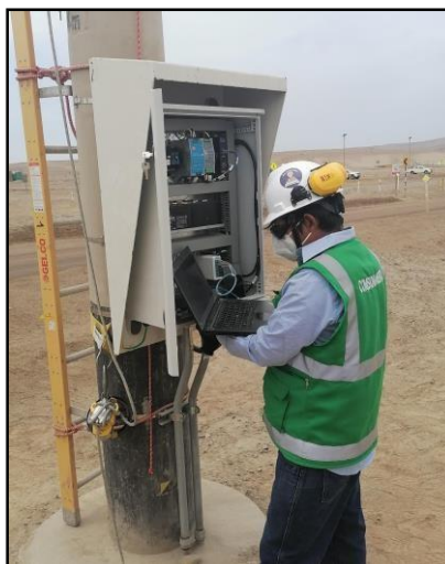
Figura 48: Verificación de funcionamiento de cámara localmente.
