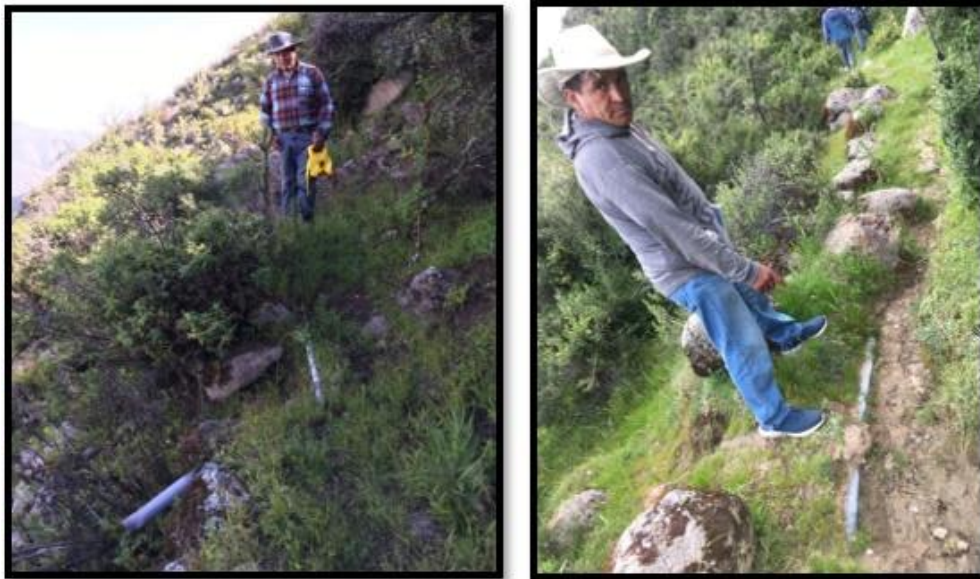
Fig. 9: La tubería expuesta a peligros externos como caída de piedras, insolacion
