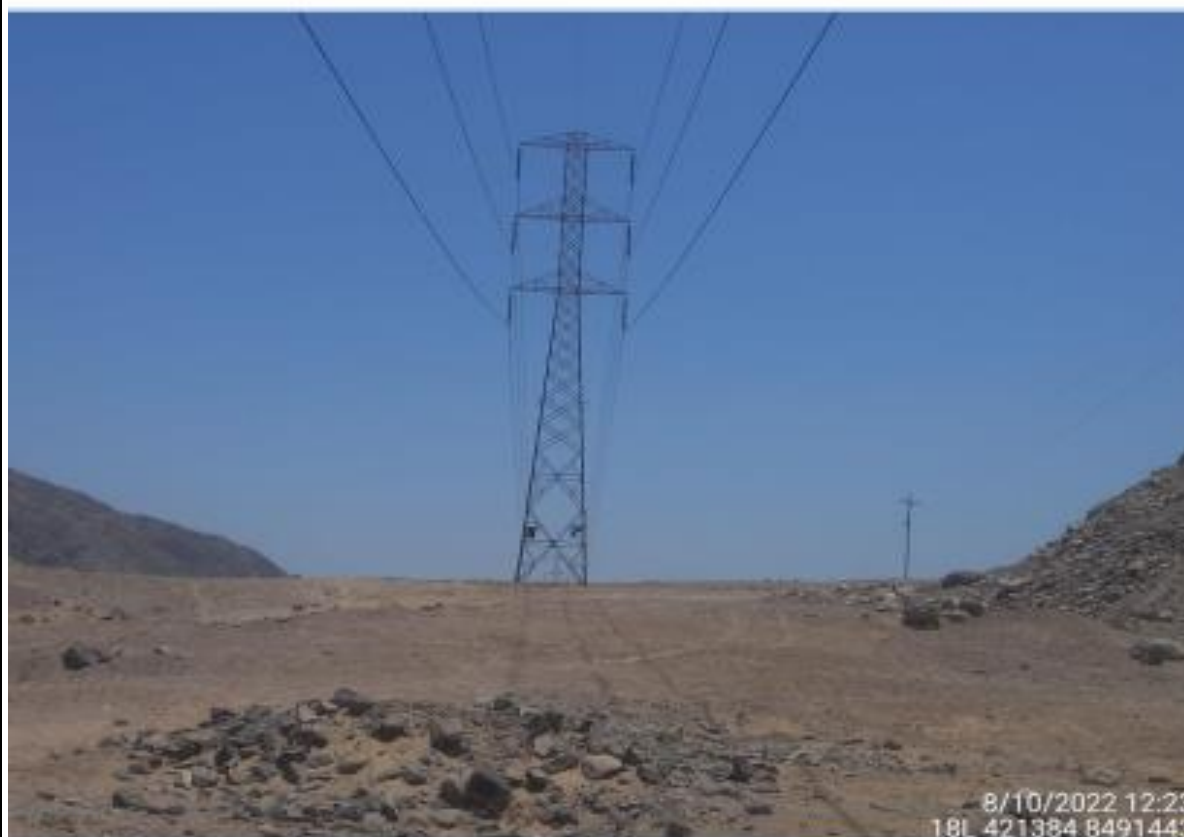
Foto N° 05 – vista panorámica de las afectaciones que presenta en el sector A.
