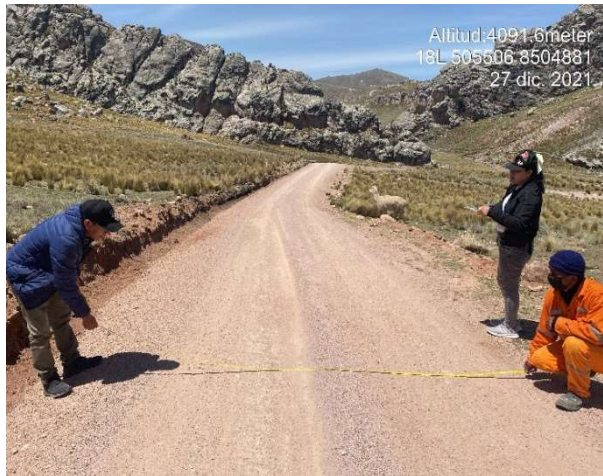
Figura 116: Evaluación del daño en la calzada en el KM 14+050.
