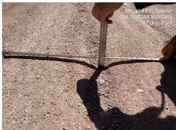
Figura 111: Medición de la profundidad de la deformación en el KM 7+370.
