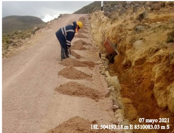
Figura 79: Bacheo de calzada en el KM 5+250.
