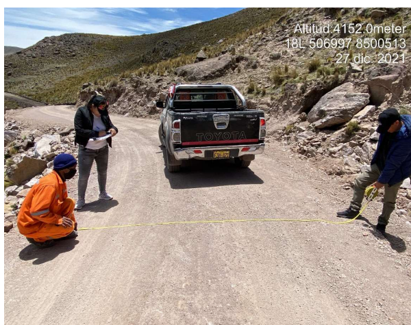
Figura 120: Medición del daño en la calzada en el KM 21+530.
