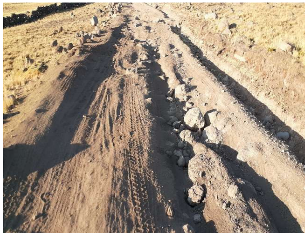
Figura 25: Deformación Tipo III en el KM 1+500.
