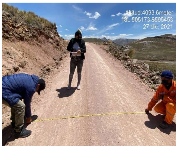
Figura 114: Medición del ancho de deformación en el KM 12+850.
