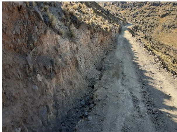
Figura 26: Erosión Tipo II y III en el KM 4+500.
