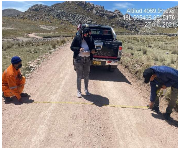
Figura 115: Evaluación del ahuellamiento en el KM 13+550.
