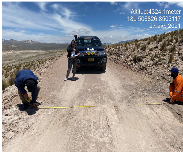
Figura 119: Medición de la erosión existente en el KM 18+150.
