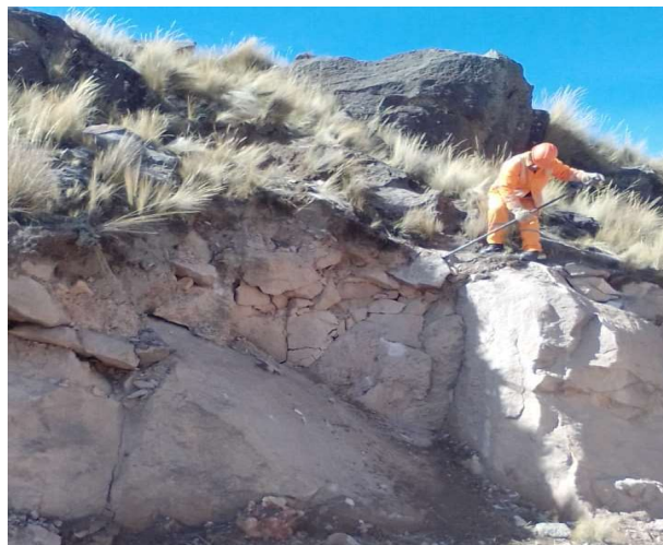
Figura 81: Desquinche en el KM 11+550.
