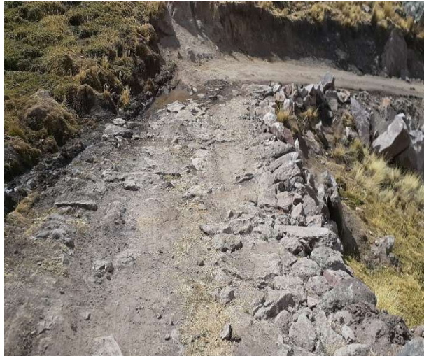
Figura 30: Perdida de capa granular de rodadura en el KM 21+000.
