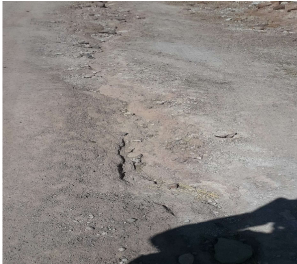
Figura 27: Erosión Tipo II en el KM 12+500.
