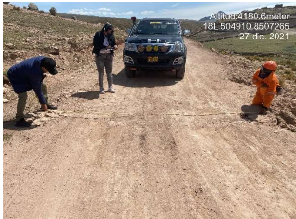
Figura 112: Medición del ancho del daño en la calzada en el KM 10+500.
