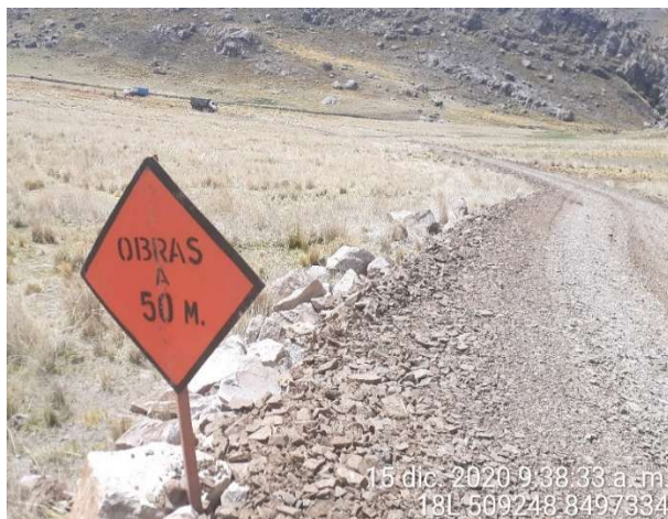
Figura 42: Señalización preventiva en el KM 26+540.
