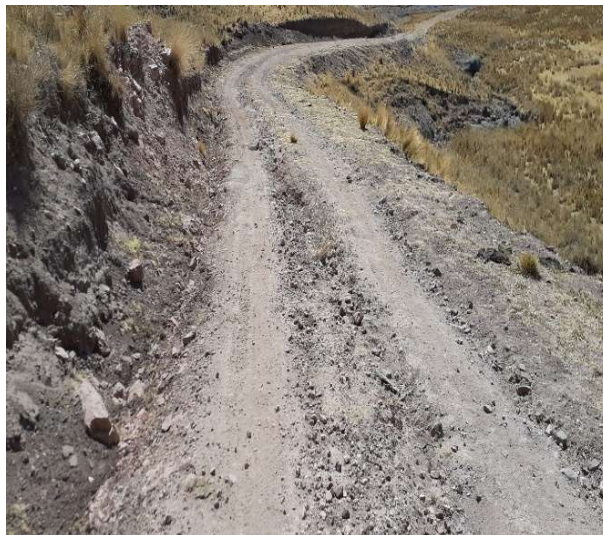
Figura 28: Deformación Tipo II en el KM 13+500.
