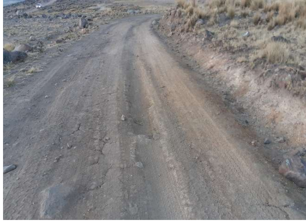
Figura 24: Deformación Tipo II en el KM 0+250.
