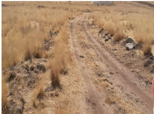
Figura 31: Vegetación en la capa de rodadura el KM 22+000.
