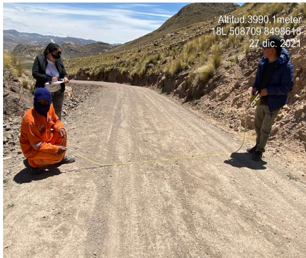
Figura 122: Evaluación del tipo de erosión en el KM 25+050.
