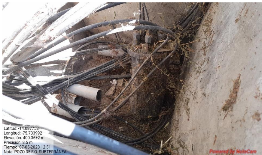
Fig. 8. Pozo subterráneo descubierto sin cuidado. [Fuente Propia]
