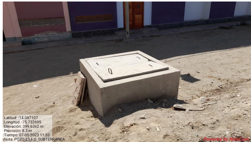
Fig. 4. Cámara subterránea de fibra óptica del recinto universitario. [Fuente Propia]
