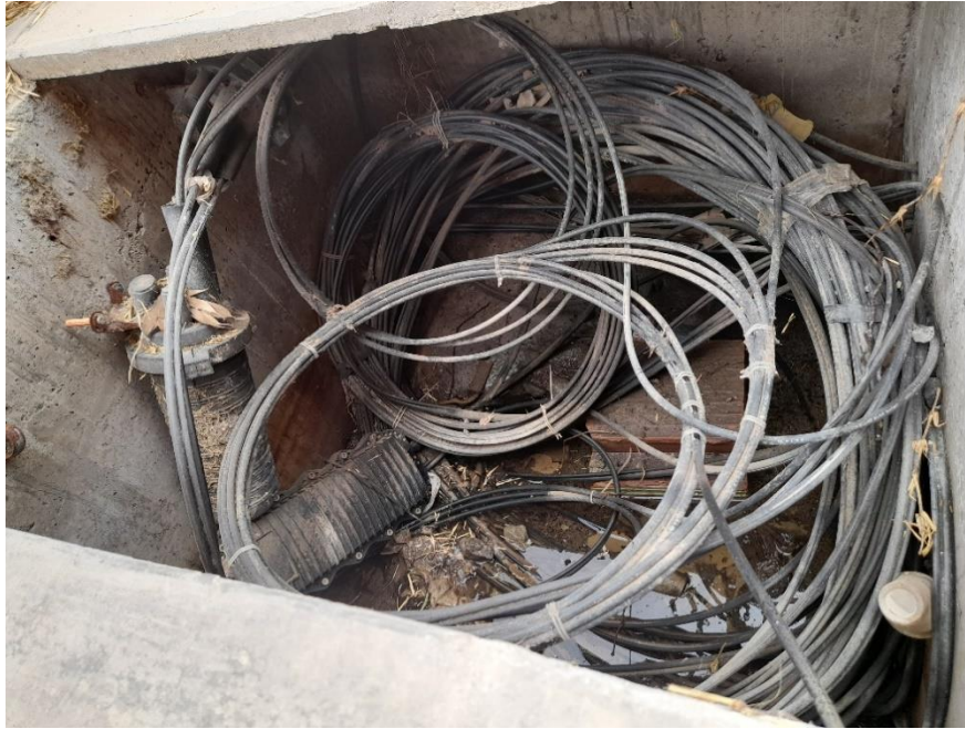
Fig. 7. Pozo subterráneo con reservas y mufas inadecuadamente implementadas. [Fuente Propia]
