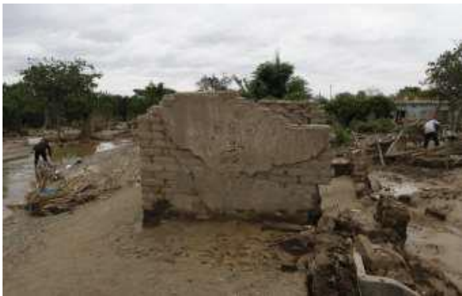
Figura 6: Vivienda de adobe afectada por huaycos.
