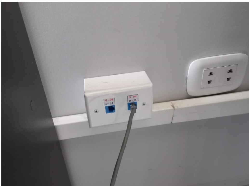
Fig. 20: Ponchado de Jack Cat 6 (Identificadores de punto de red)
