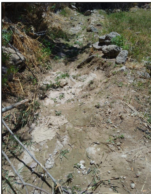
Figura 1. Vista de una zona de desborde del canal
