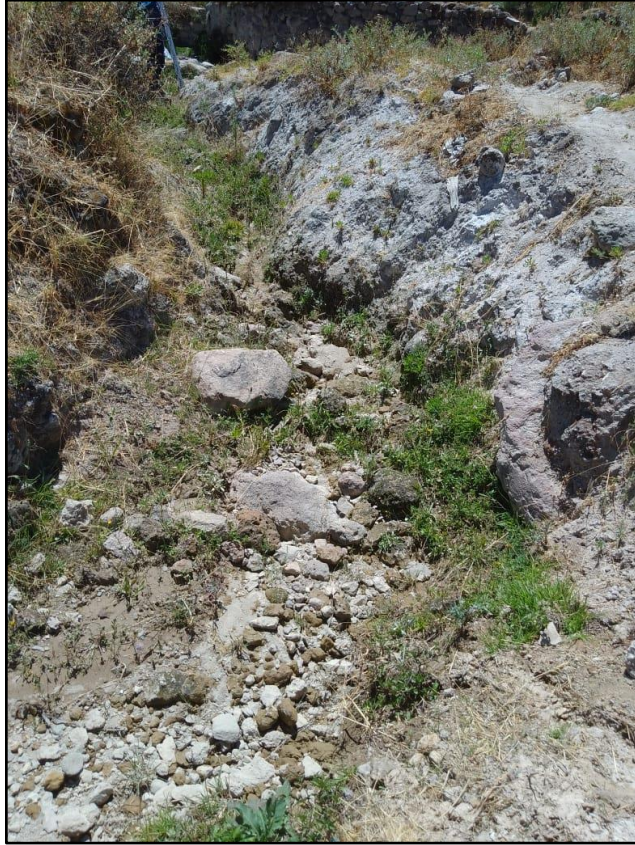
Foto 5: Vista de zona de infiltración en el canal.
