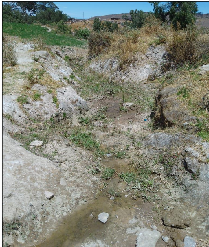
Figura 3. Vista de las irregularidades de la sección del canal
