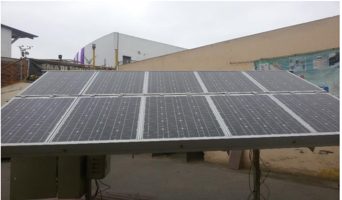
Figura 11. Panel o Arreglo fotovoltaico.
