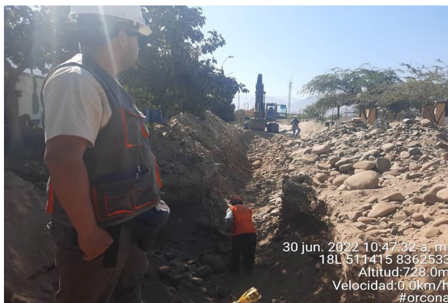
Figura 17. Excavación de zanja donde se aprecia las piedras mayores a 3 pulg. Se verifica que producto al material encontrado en los trabajos de excavación de zanjas, los rendimientos para estas partidas no se ajustan a lo estipulado en el expediente técnico.
