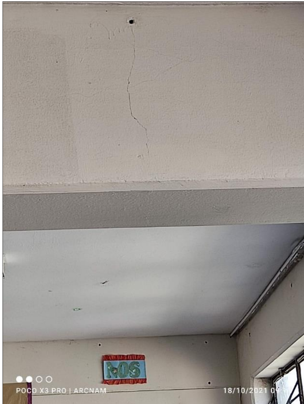
Fig.48 Fisura en viga peraltada del segundo nivel.
