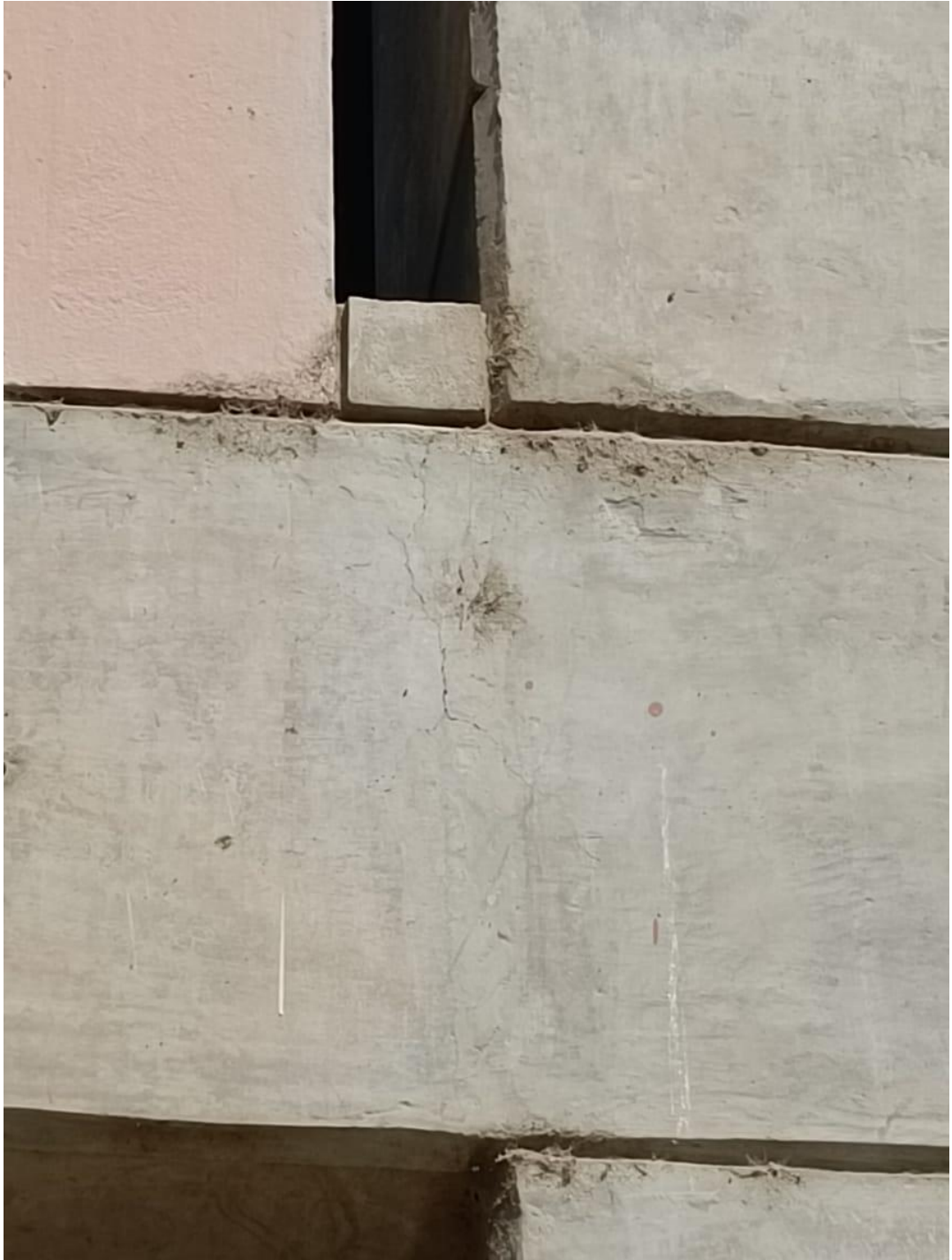
Fig.58 Fisura en la sección de viga peraltada
