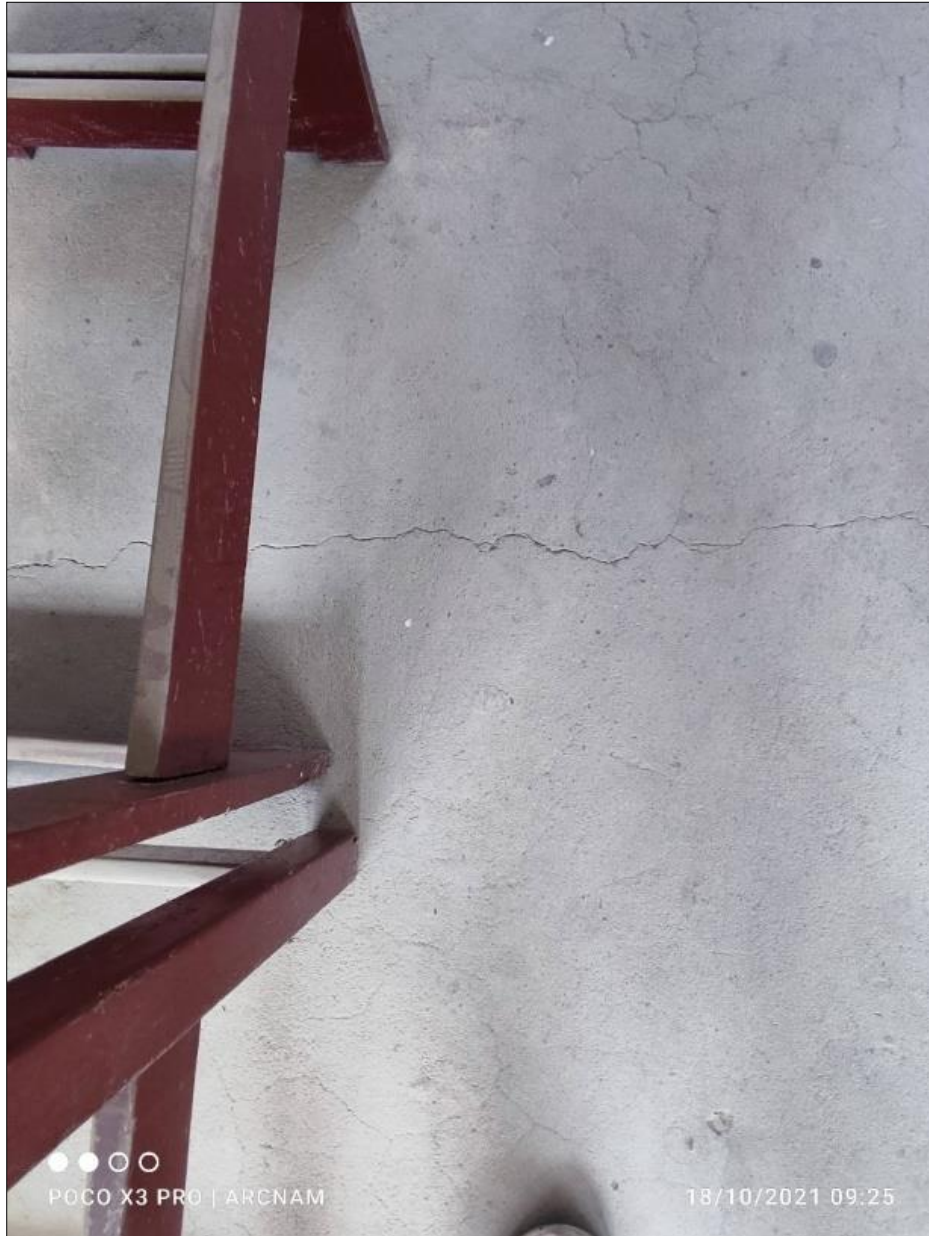
Fig.47 Fisuras en losas del segundo nivel.
