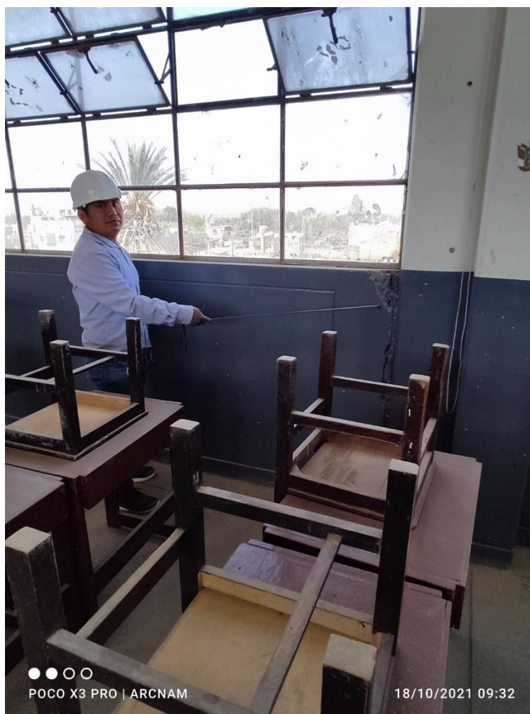
Fig.55 Se observa grieta en las vigas secundarias de los muros del tercer nivel.
