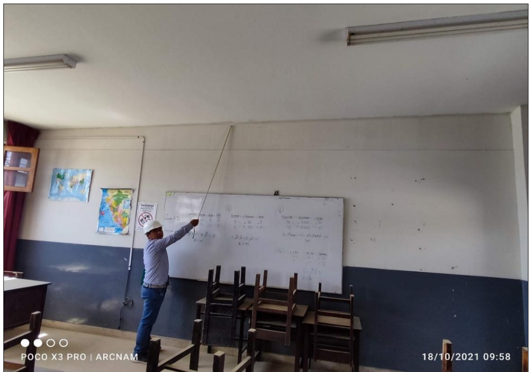
Fig.26 Buena conexión de diafragma con muro portante en aula 02.
