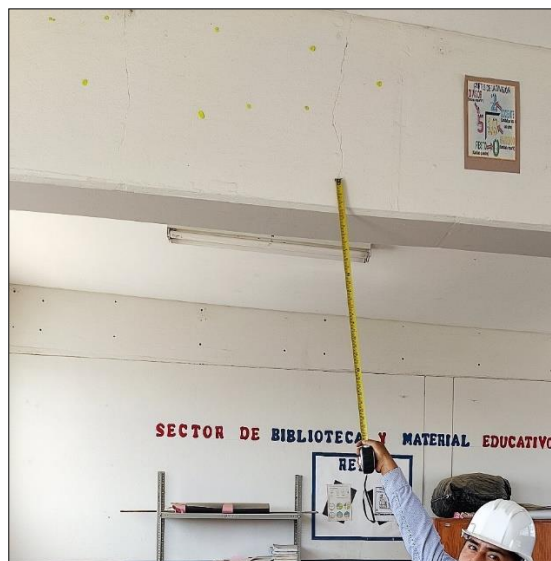
Fig.35 Fisuras en vigas del primer nivel
