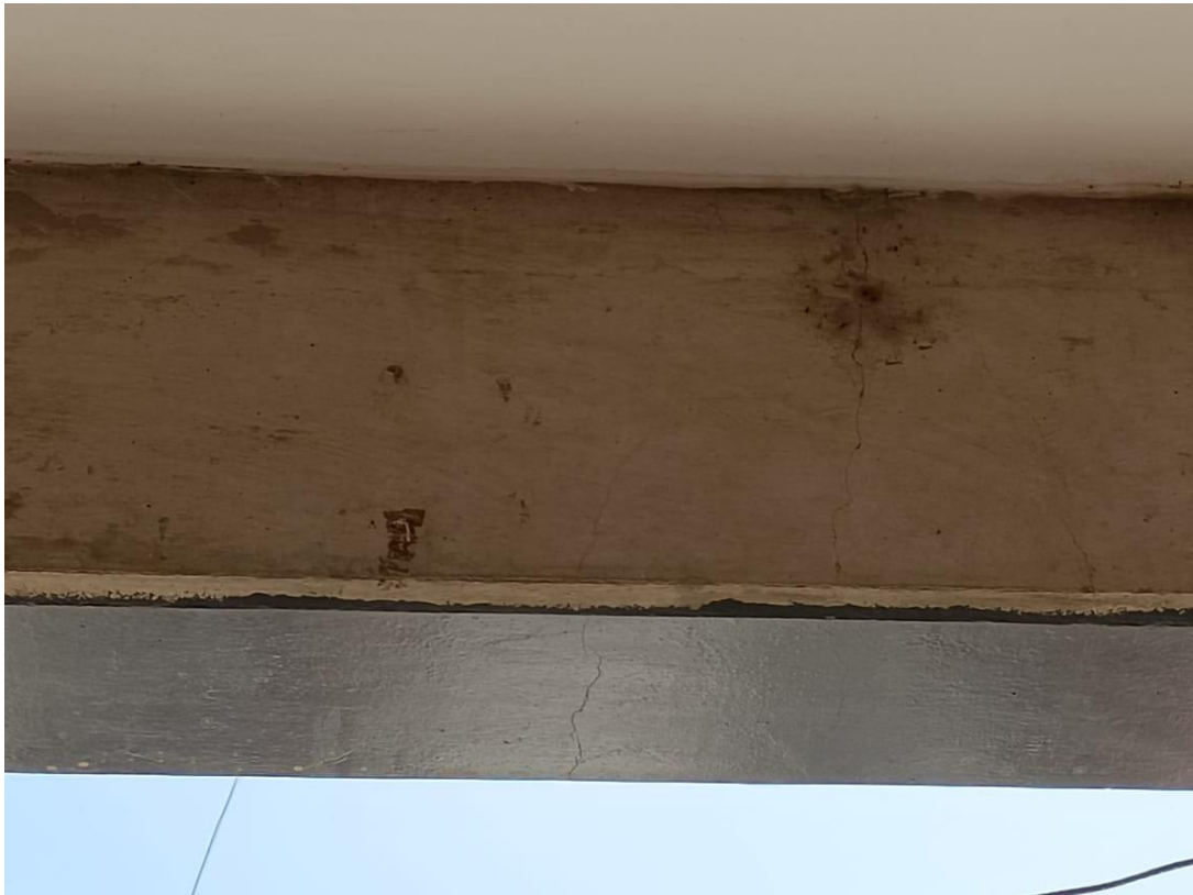
Fig.56 Fisura vertical en la parte superior de sección de viga peraltada
