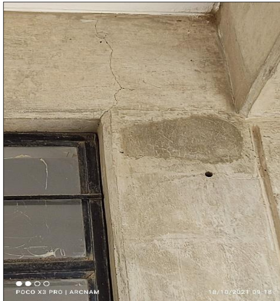
Fig.34 Fisuras en unión de columnas con vigas del primer nivel.
