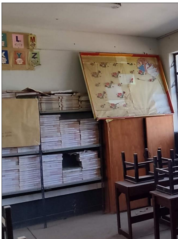
Fig.45 Presencia de elementos no estructurales-equipamiento de aulas
