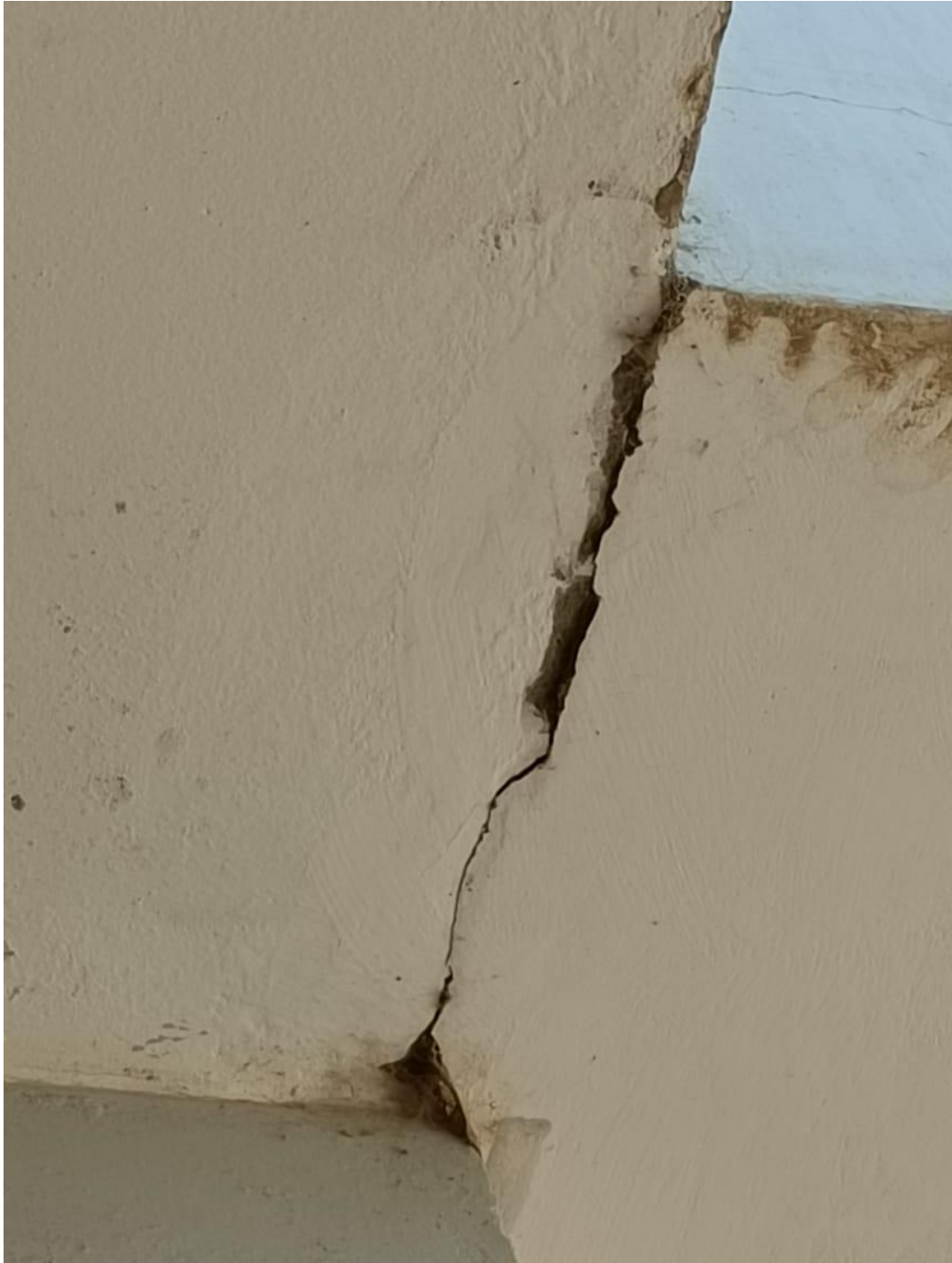
Fig.59 Grieta en la parte inferior de la losa aligerada-cruce entre columna y viga.
