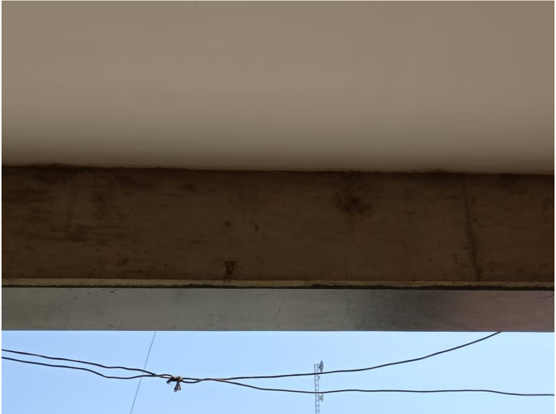
Fig.57 Fisura vertical en la sección de viga peraltada
