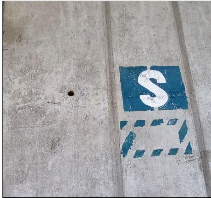
Fig.36 Fallas en tarrageo del primer nivel.
