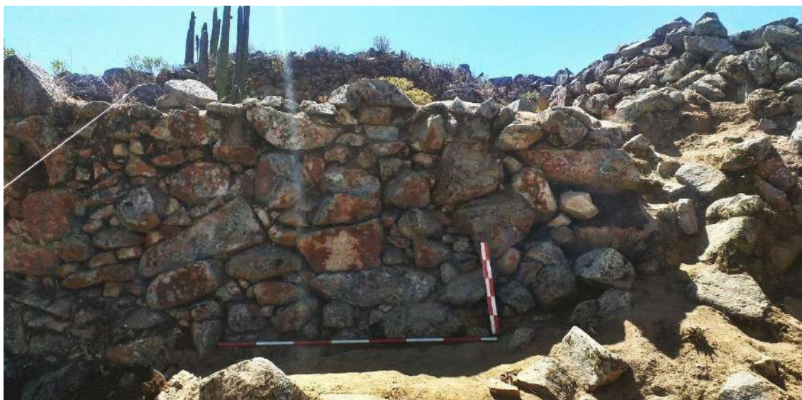
Figura 34. Paramento externo del muro de contención 01 donde se aprecia el colapso demuro en el lado derecho
