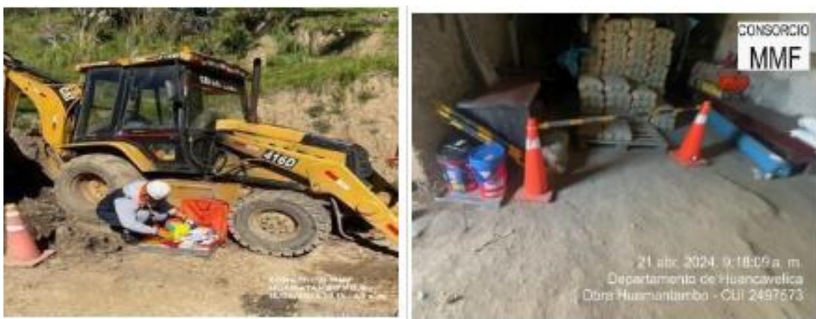
Bandeja antiderrame debajo de equipo estacionado Bandeja antiderrame en Almacén
