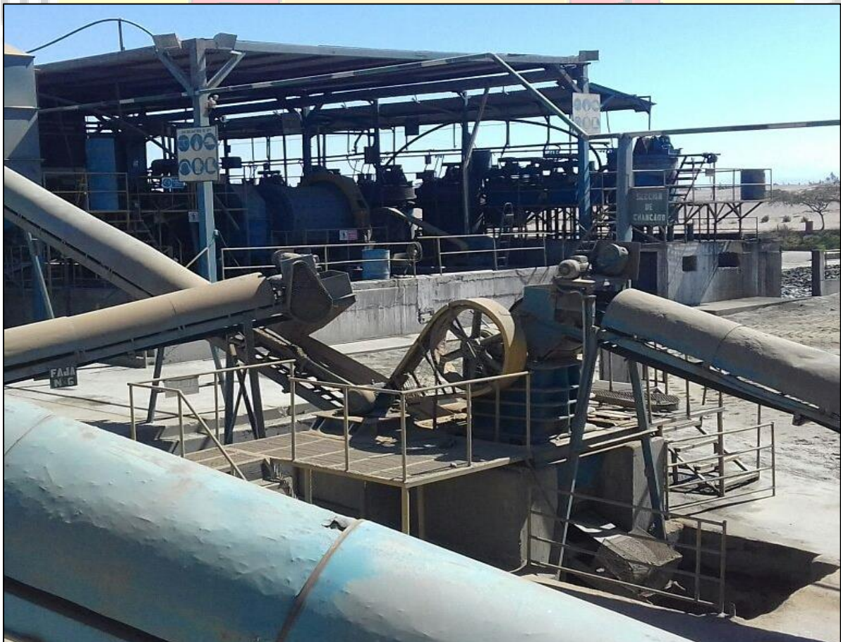
Figura 18: Molienda – Clasificación y circuito de flotación al fondo
