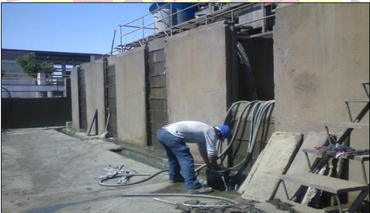
Figura 22: Cifoneo de agua para recircular, de las pozas de sedimentación de concentrado
