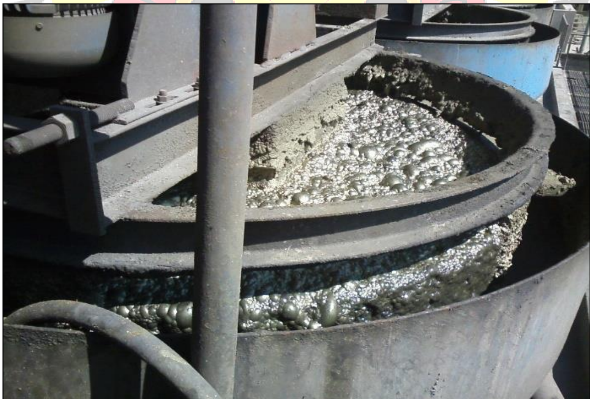
Figura 20: Celda de flotación "W. Serrano"
