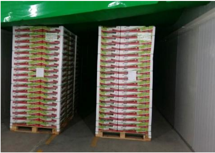
Figura 16. Túneles de frío. Fuente: Empresa exportadora de uva. (2015).
