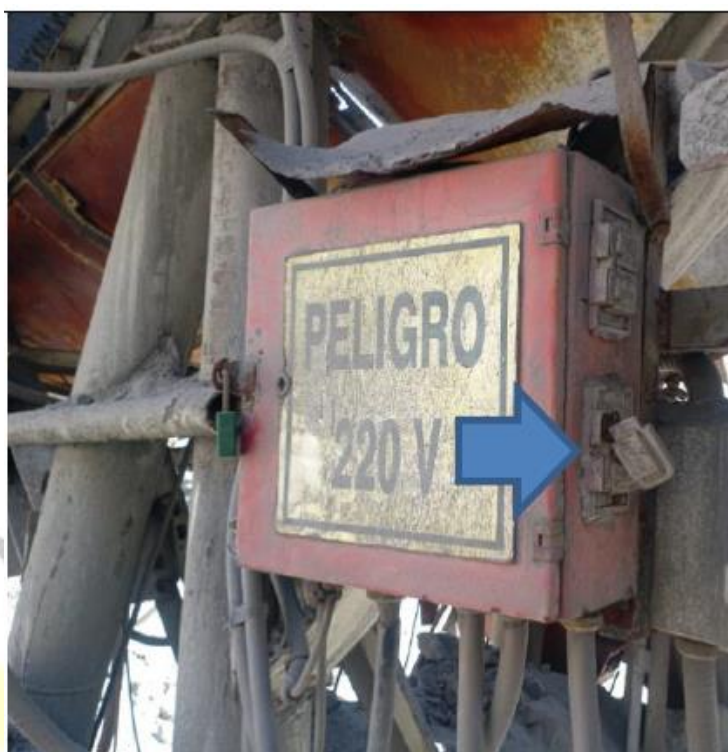
Figura 7. Ubicación de toma 220 V conexión domiciliaria ubicado en locotruck 2
