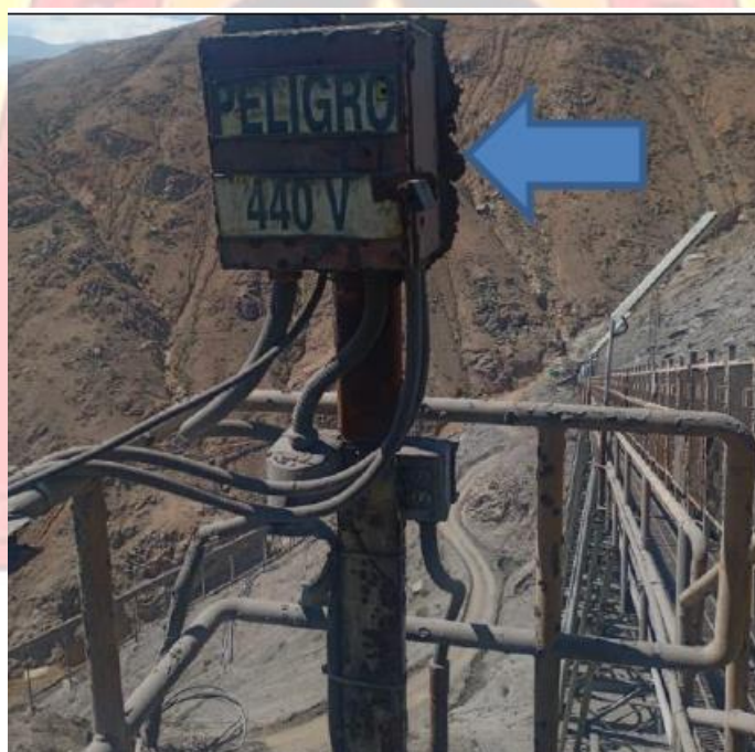
Figura 13. Zona 2 Ubicación de toma 440 V/220 V ubicado en la cabeza de la faja 5
