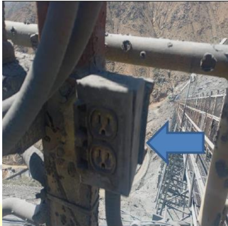
Figura 18. Zona 4 Ubicación de toma 220 V ubicado en la cabeza de la faja 5
