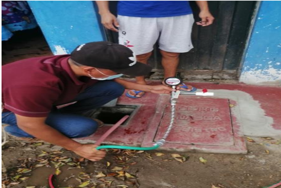
Fig. 10. Toma de presión en la calle Manco Cápac 188 del sub sector. 09
