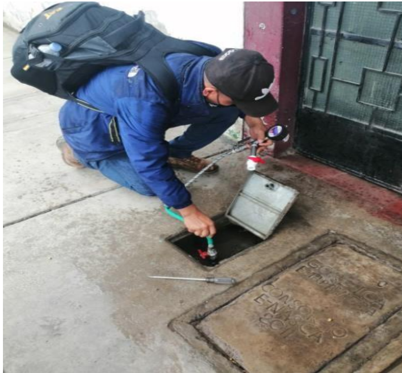
Fig. 35. Vista de toma de presión de campo con manómetro en la calle centenario del sub sector 09.
