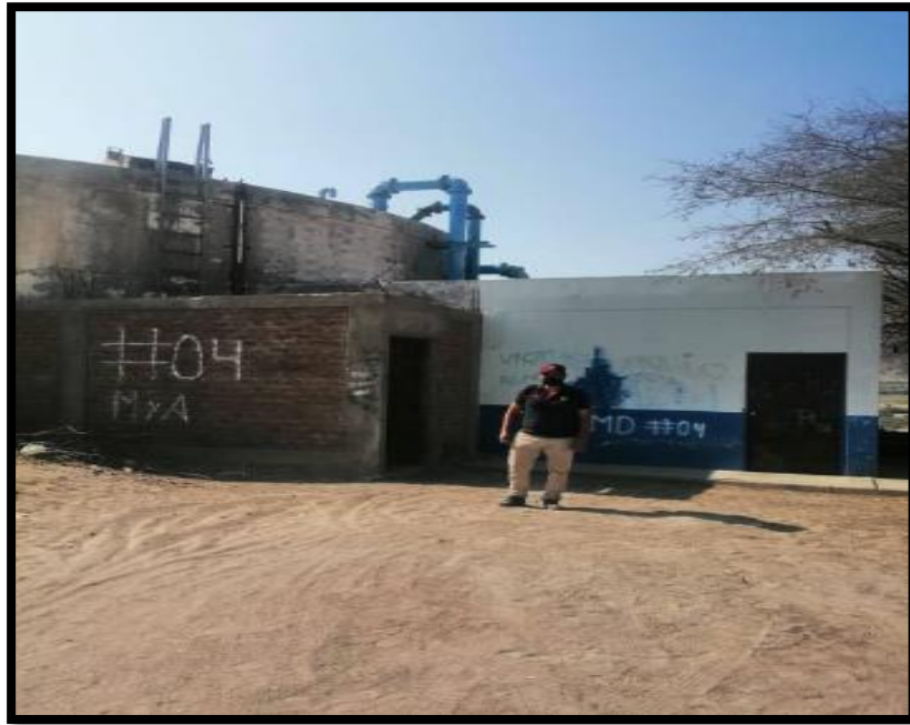
Fig. 39. Vista del reservorio 1000 m 3 que brinda servicio de agua al sub sector 09.
