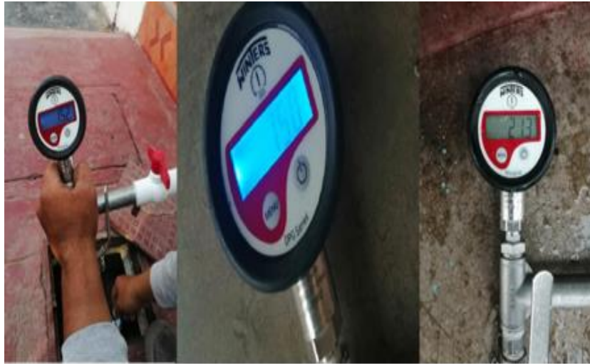
Fig. 37. Vista de lectura de presiones del sistema tomadas por el manómetro digital.
