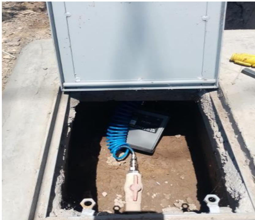
Fig. 34. Equipo de Dataloggers instalado en la calle chincha 345 del sub sector 09.
