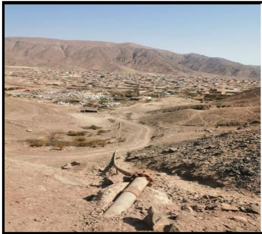
Fig. 40. Vista de línea de aducción de 6" existente para el sub sector.
