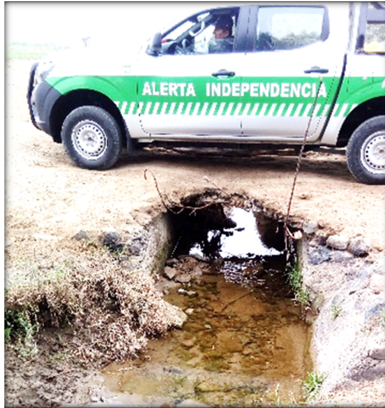
Fig. 6 – Estado actual de Pontones (fuente – Expediente Técnico- Panel fotográfico)
