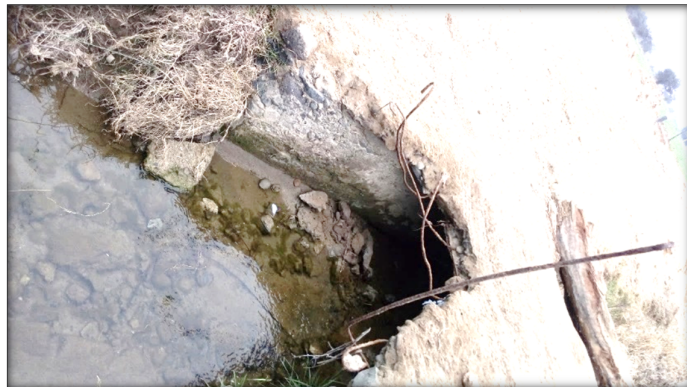
Fig. 5 – Estado actual de alcantarillas
