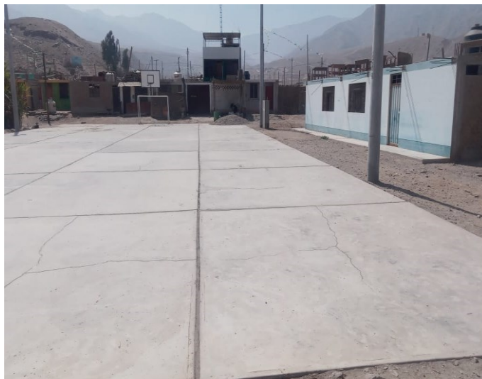
Fig. 2. Estado previo a intervención de losa deportiva ubicada en el centro poblado Pallasca.
