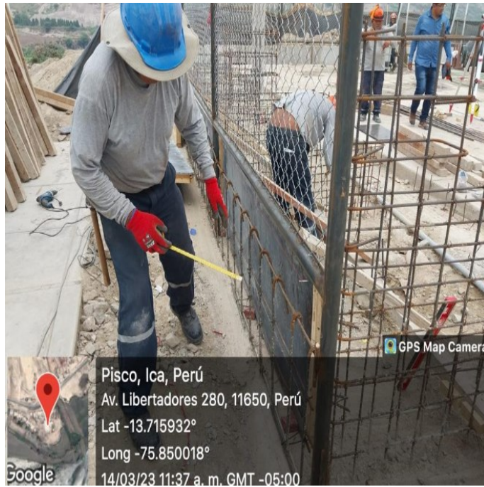
Fig. 54. Armado del encofrado para la base de los apoyos del cerco con malla galvanizada
