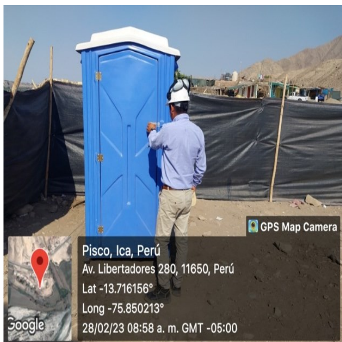
Fig. 16. Vista de la verificación de los servicios higiénicos portátiles
