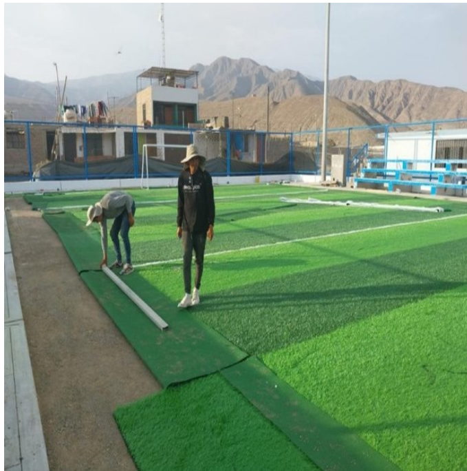
Fig. 78. Vista de la verificación de la cama de arena y grass sintético
