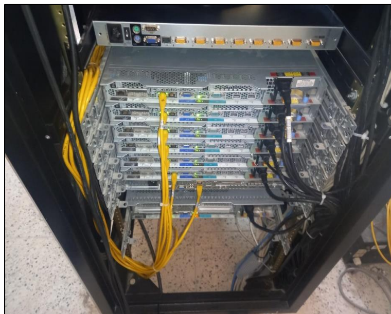
Fig. 17. Cables organizados de la parte inferior de atrás del gabinete
