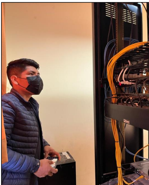
Fig. 66. Observando el estado del Data center.
