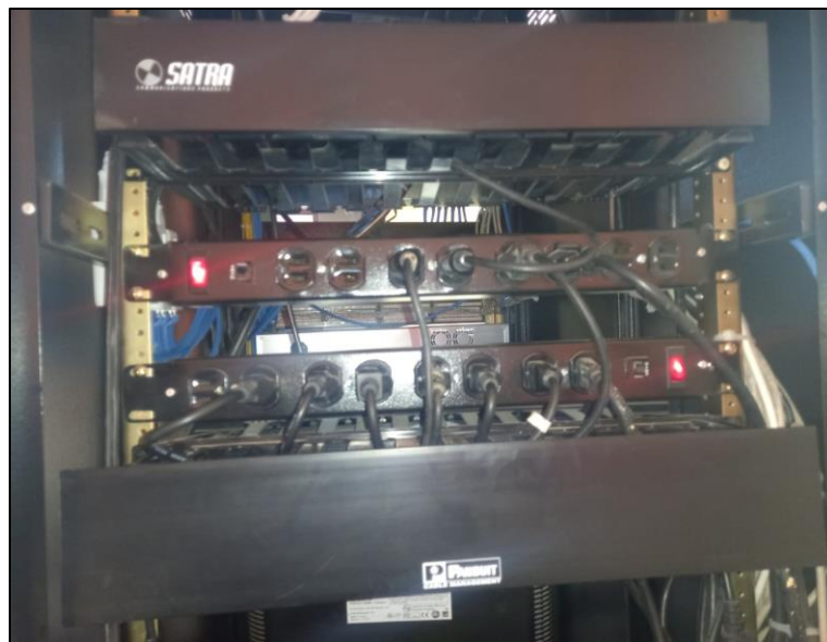
Fig. 16. Cables organizados de la parte superior de atrás del gabinete
