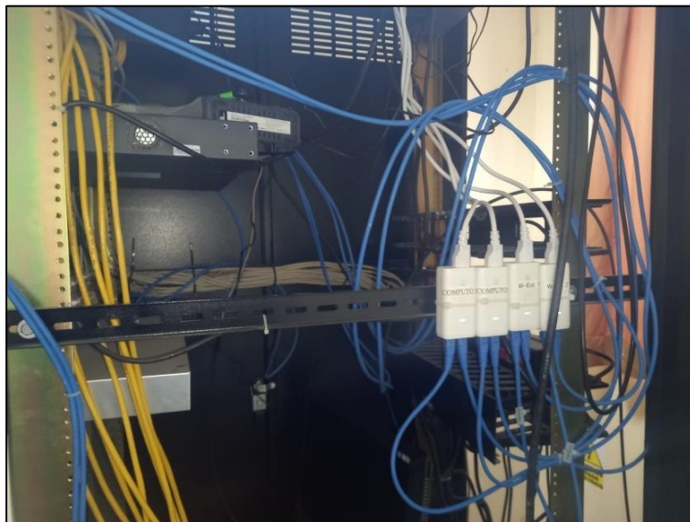
Fig. 12. Cables sueltos y desorganizados de la parte superior derecha del gabinete
