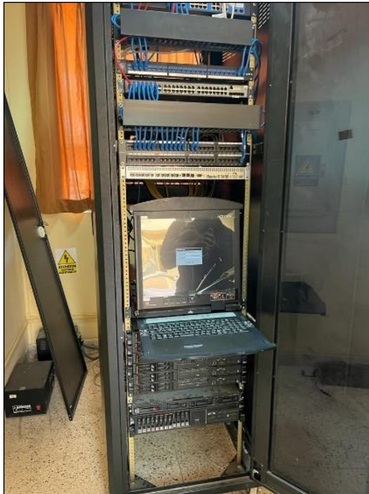
Fig. 2. Estado actual del data center
