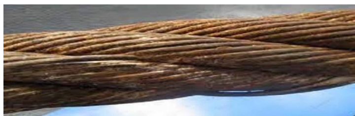
Fig. 5 Foto de Conductor con presencia de corrosión
