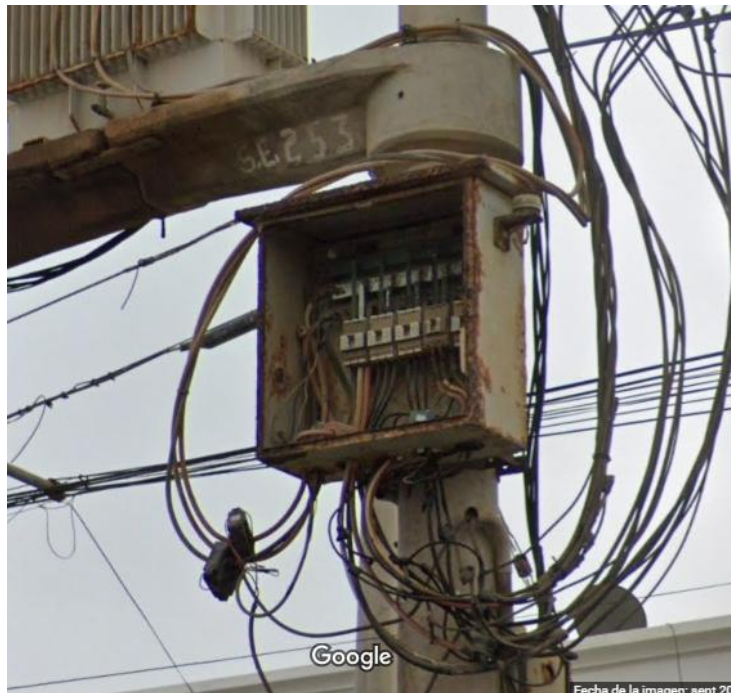
Fig. 8 Foto de Tablero de Distribución Afectado por la Contaminación Atmosférica
