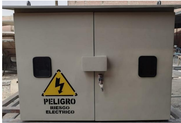
Fig. 18 Tablero de Distribución de fibra de vidrio
