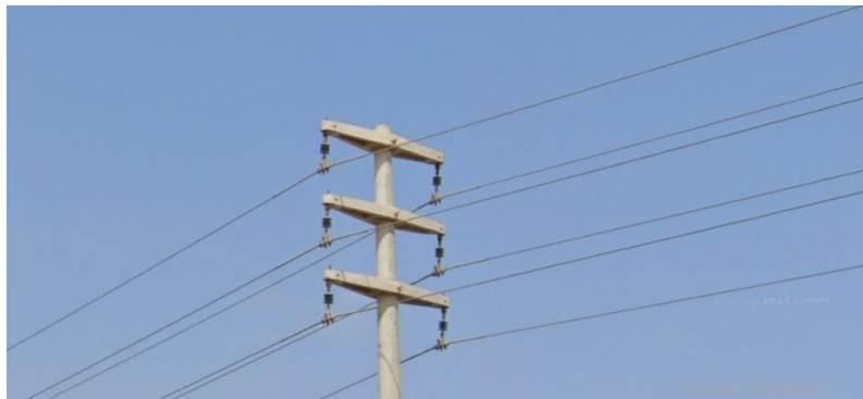
Fig. 4 Foto: Red Aérea Trifásica en Doble Terna AAAC 120mm 2
