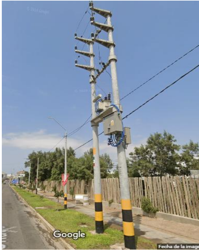
Fig 7 Foto de Subestación de Distribución Típica
