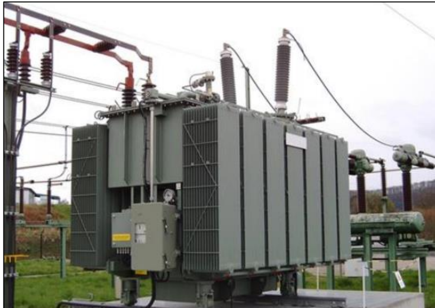
Fig. 4. Transformador de potencia
