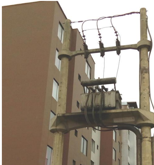
Fig. 15. Inspección visual – Detección de derrame de aceite.
