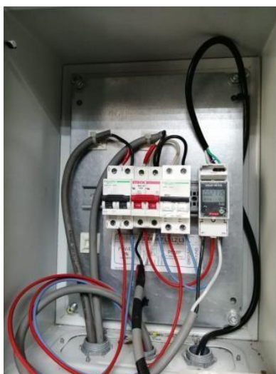
Figura 5. Fotografía del tablero de control.
