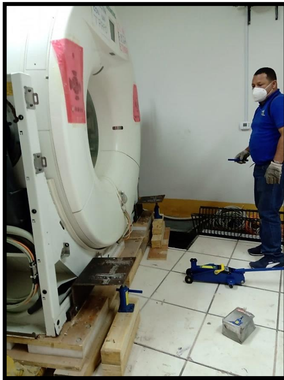
Fig. 19. Área de Diagnóstico por Imágenes “Hospital San José” de Chincha
