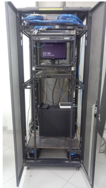
Fig. 5. Estado gabinete de comunicaciones (b)
