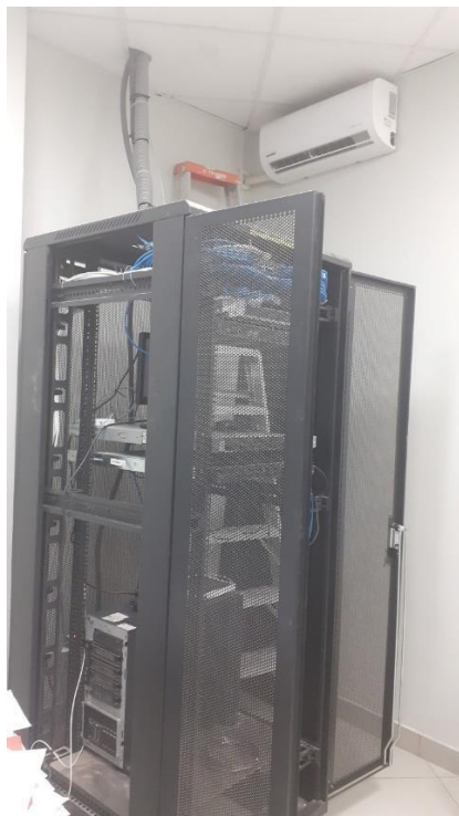
Fig. 4. Estado del gabinete de comunicaciones (a)
