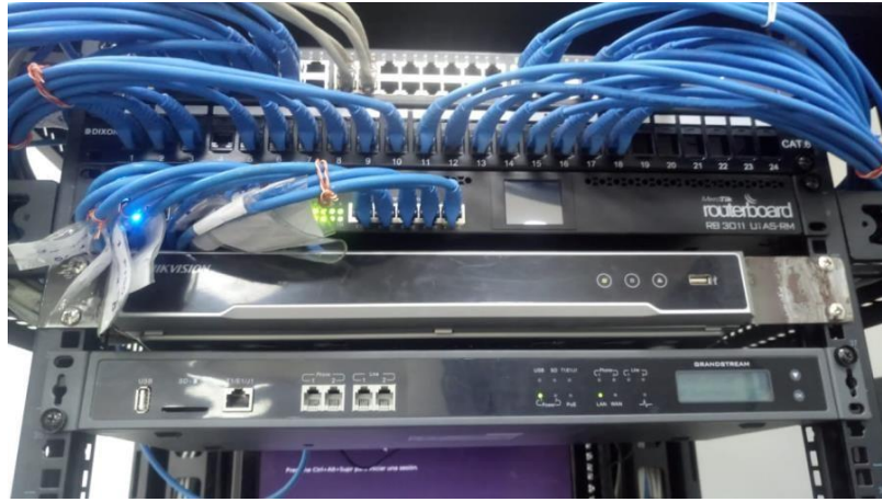
Fig. 6. Estado del router Microtik
