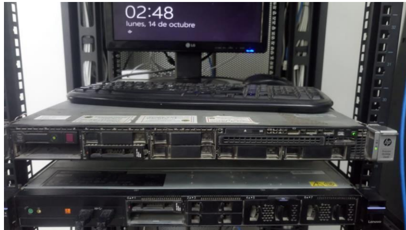
Fig. 3. Estado del servidor después del mantenimiento
