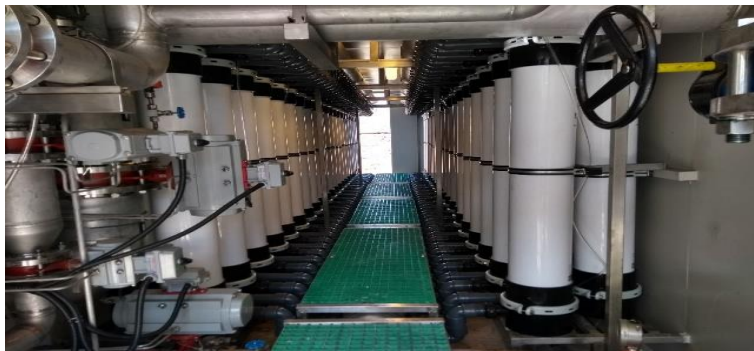
Fig. 6 Área de ultrafiltración
