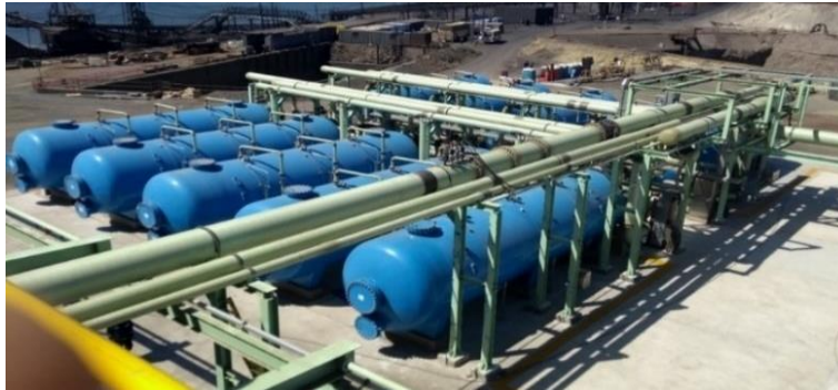
Fig. 4 Área de filtros de arena
