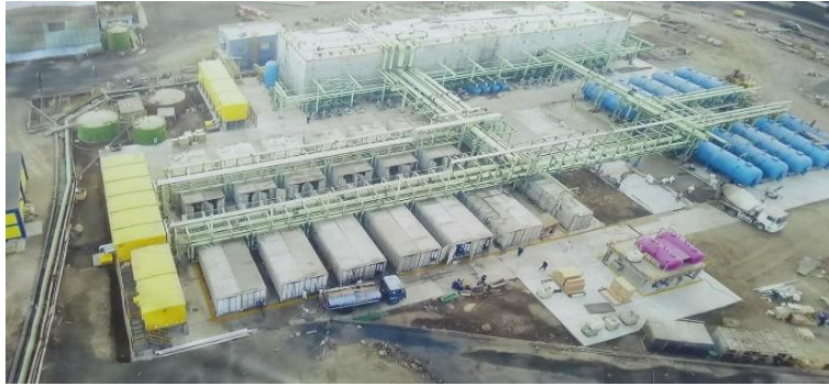
Fig. 3 Vista aérea de planta desalinizadora de agua de mar.
