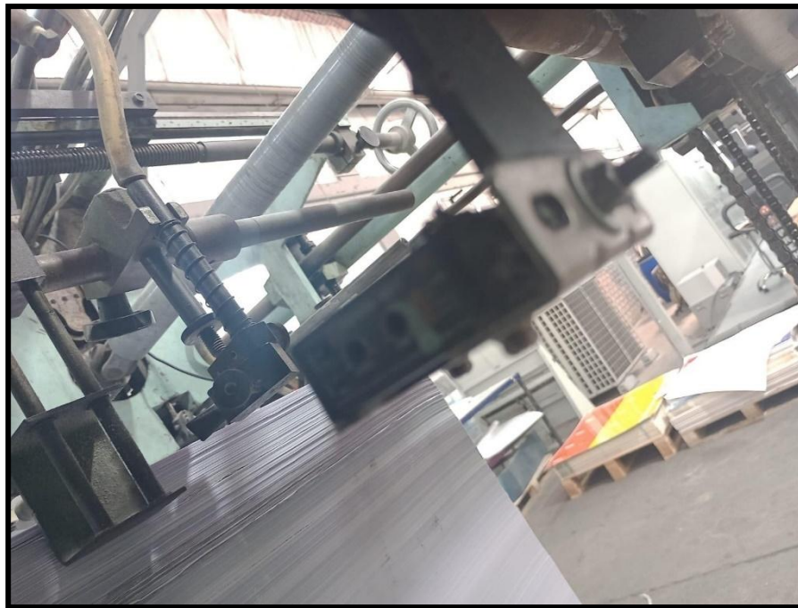
Fig. 14: Sensor fotoeléctrico nuevo instalado en mesa de entrada de máquina impresora
