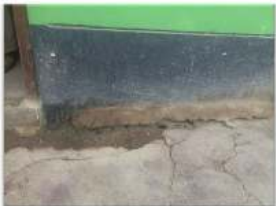
Foto 12. Se observa los cimientos expuestos de vivienda.
