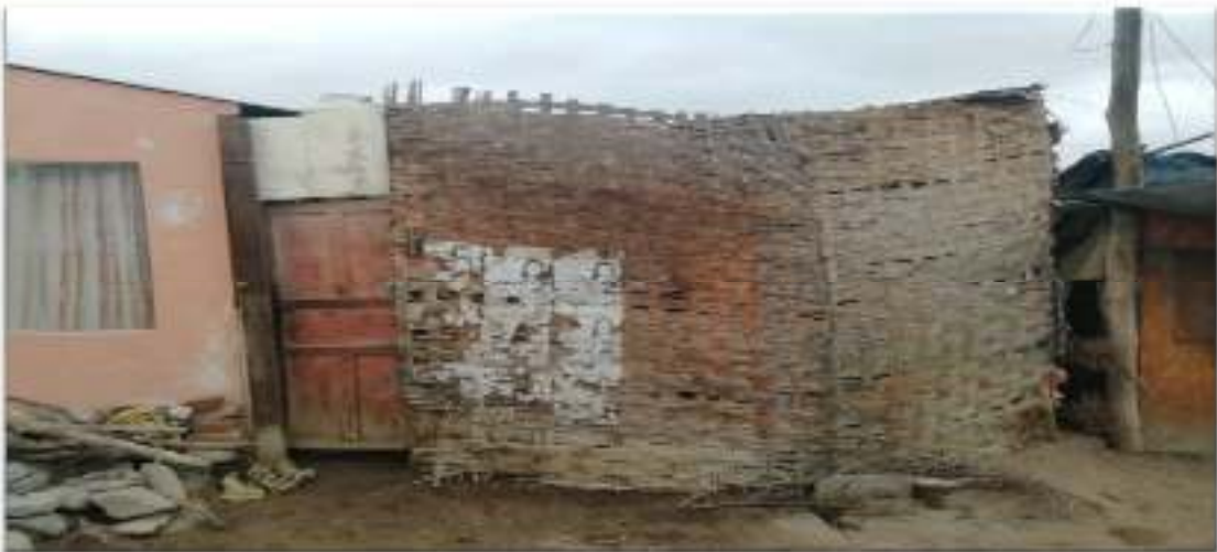
Foto 7. Vivienda en estado de deterioro, construida de estera.
