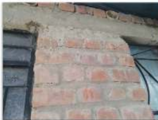
Foto 15. Agrietamiento de muro y se observa un mal proceso constructivo en la cobertura.
