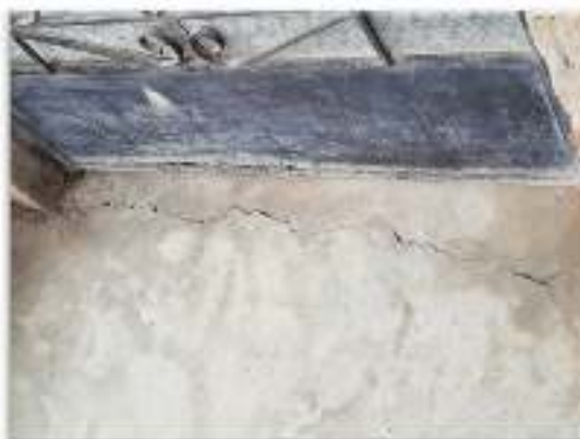
Foto 13. Agrietamiento en veredas y accesos de las viviendas en el Centro Poblado Los Juárez.
