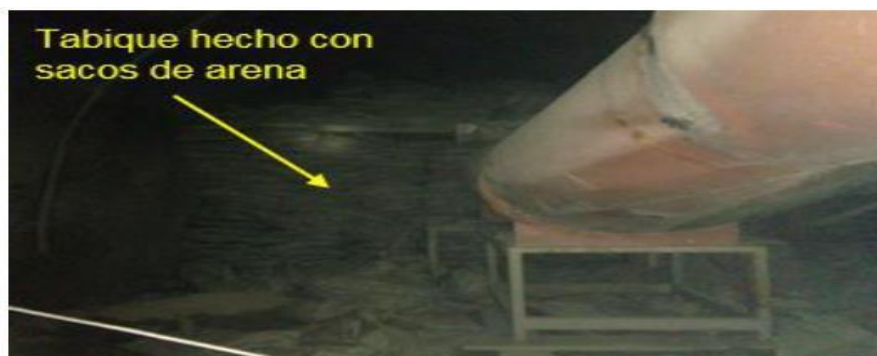
Figura 6. Tabique hecho con sacos de arena en una instalación auxiliar
