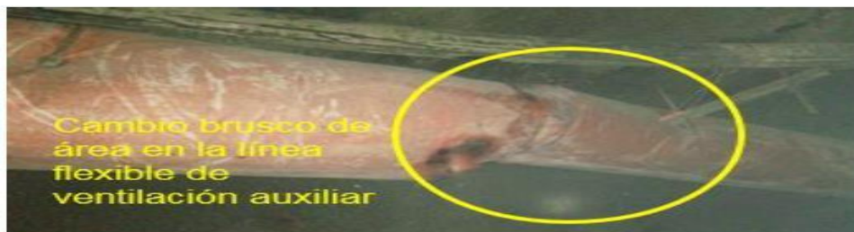
Figura 5. Cambio abrupto en el diámetro de dos ductos de ventilación empalmados
