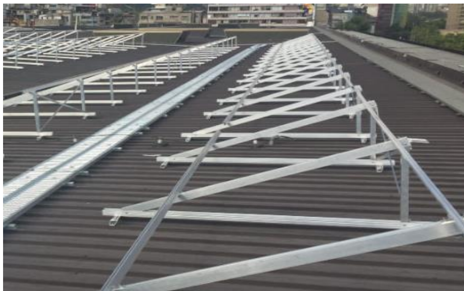
Fig. 8 Estructura metálica para paneles solares
