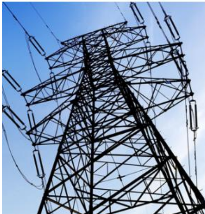
Fig. 24 Estructura de barra línea de transmisión
