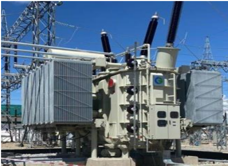
Fig. 23 Transformador elevador de potencia
