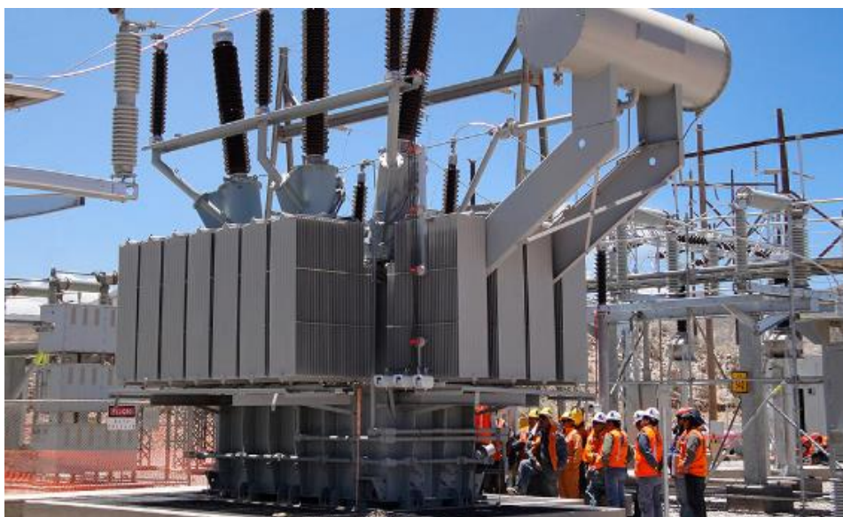
Fig. 9 Transformador de potencia 20 MVA, 23/220 KV
