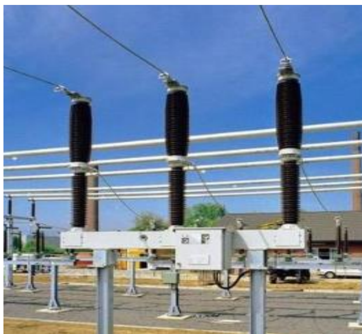
Fig. 22 Interruptor de potencia
