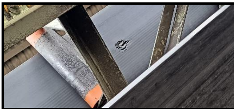
Fig. 7. Faja desgastada con agujero (sin sensor)
