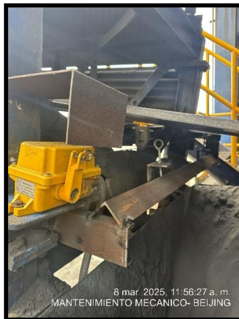
Fig. 9. Implementación de sensor de ruptura de faja
