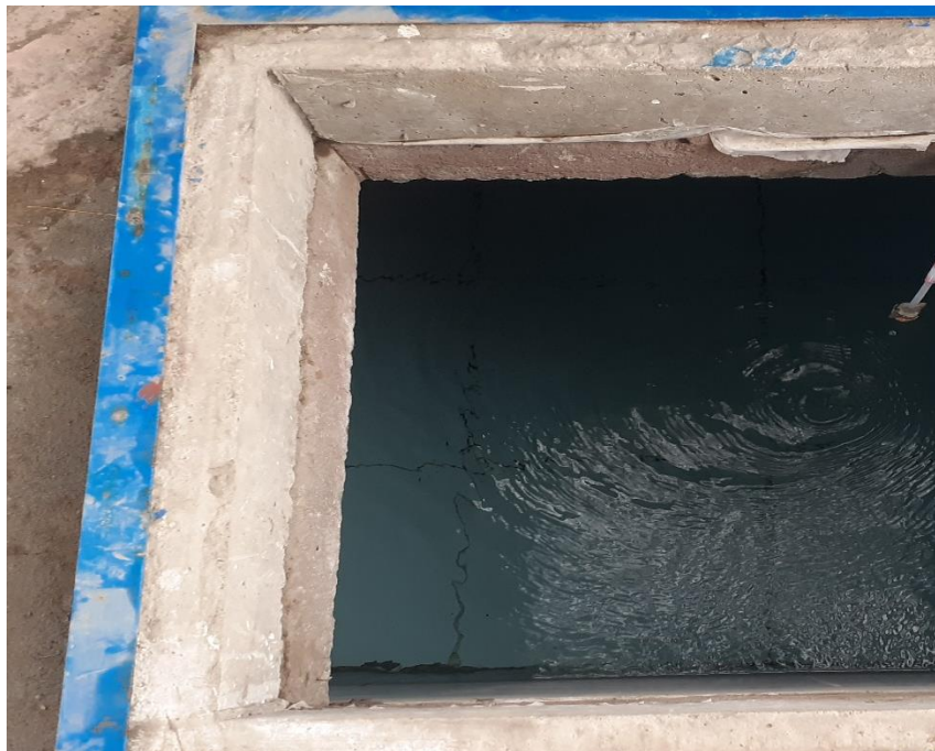
Figura 6. Filtración de la PETAP del centro poblado CHAVIN . Recopilación propia
